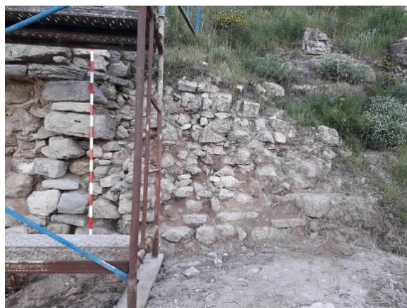
Detall del procés d'execució dels treballs de les actuacions de condicionament del mur (ue 501) que es van portar a terme. A la dreta s'observa el nivell d'enderroc del mur (ue 503).
