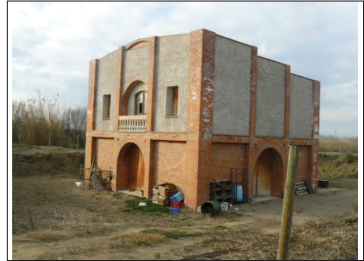
Foto 45: A.P. 5, Construcció de planta quadrada amb coberta a doble vessant, per a ús probable com a vivenda que no s'ha acabat d'construir.
