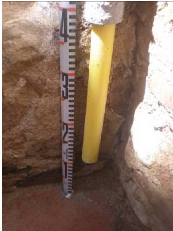
Foto 6: Finca núm. 27. Detall enlluït del mur UE 3 i mur actual de façana UE 5
