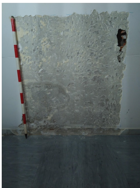
Fig. 23.-Fotografia de la capa de formigó i totxanes que componen l'envà que funciona a partir de la reforma de 1979.
