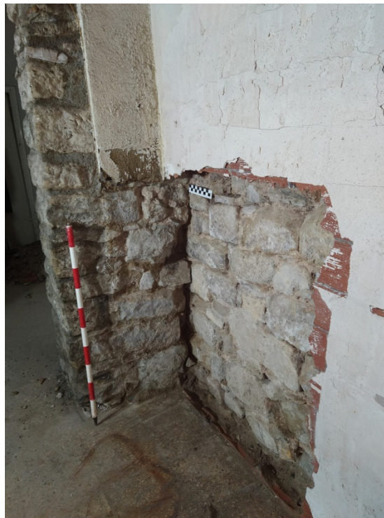
Fig.96.-Fotografia final de la Cala parietal 1, amb especial èmfasi en les relacions físiques entre el mur i l'arc.
