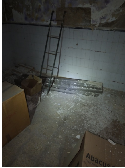
Fig.130.-Fotografia del sostre d'uralita sense retirar de l'edifici de l'antiga creu roja.
