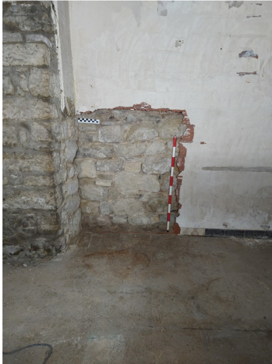
Fig.95.-Fotografia final de la Cala parietal 1.
