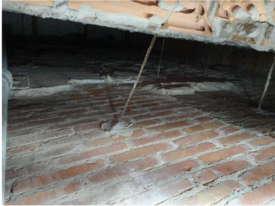
Fig.34.-Fotografia de l'interior de la Cala parietal 3, enfocada al mur de tancament de la "sala gòtica".
