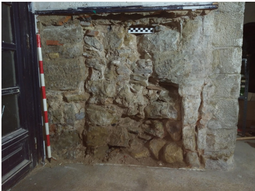
Fig.98.- Fotografia final de la Cala parietal 2.
