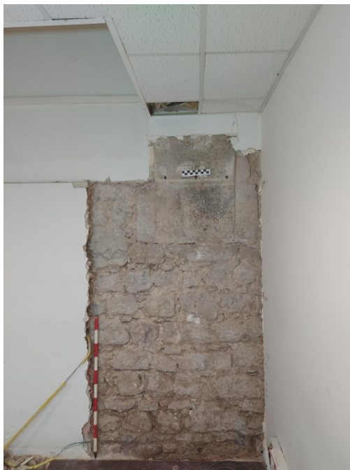
Fig.36.-Fotografia final de la Cala parietal 4.
