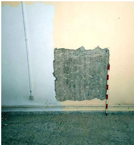
Fig.39.-Fotografia final de la Cala parietal 5
