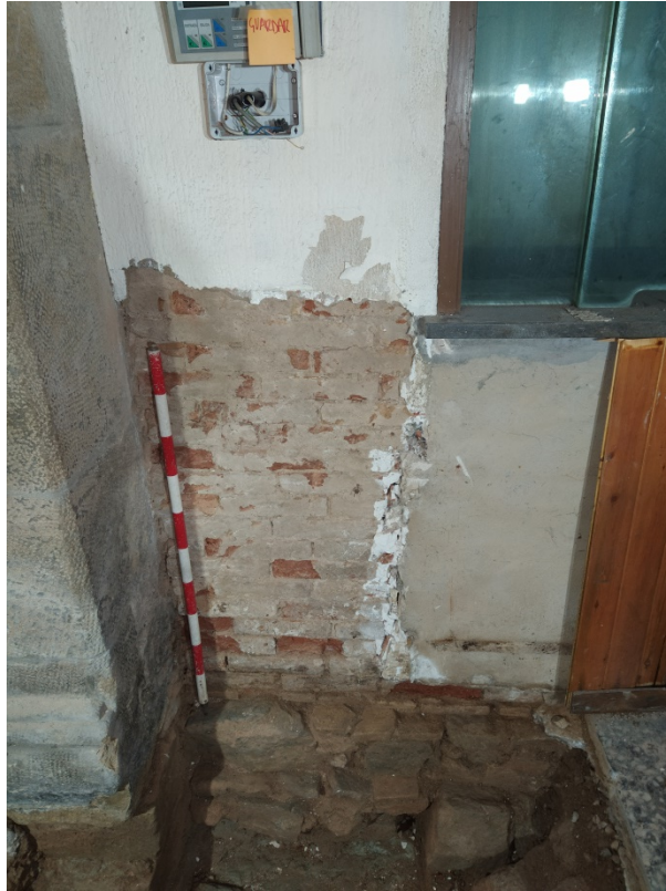
Fig.104.-Fotografia final de la cala parietal 4.
