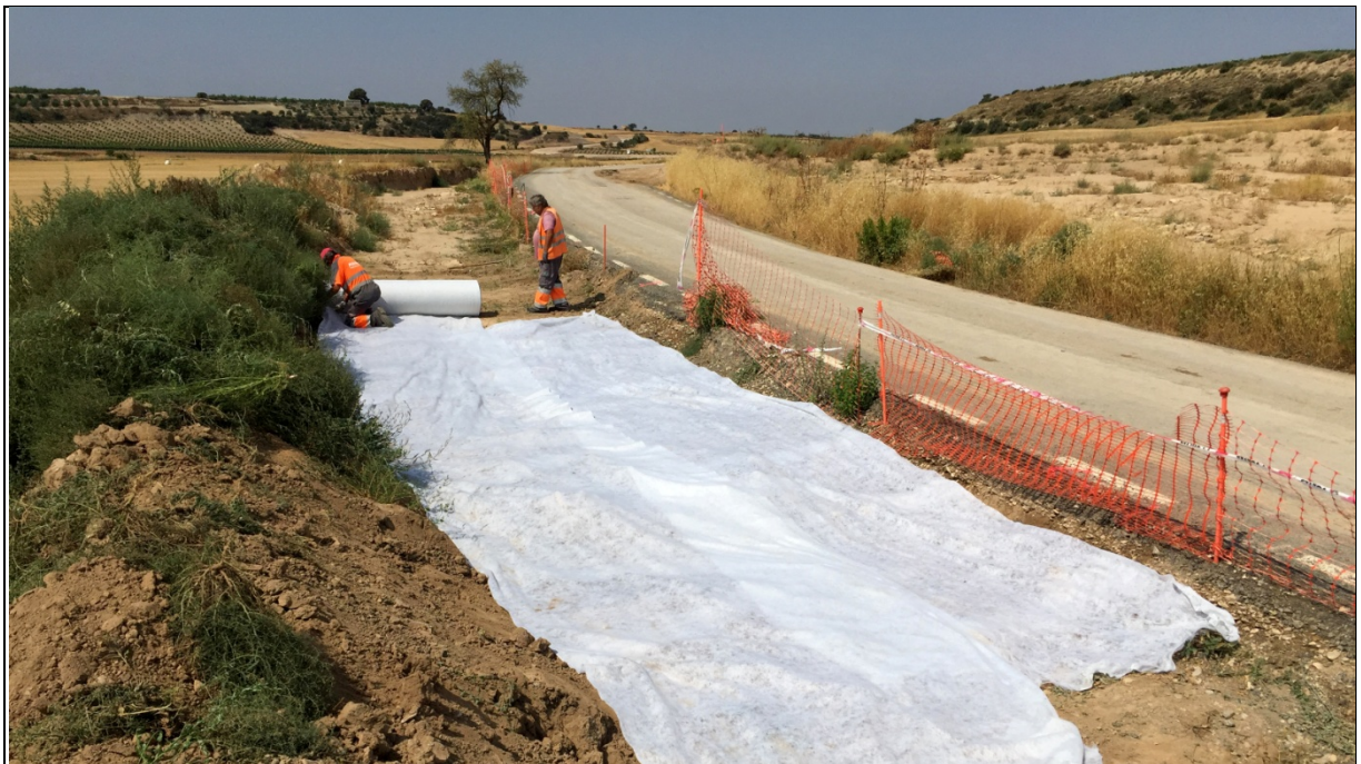
FOTO 15. Vista dels treballs de cobriment amb geotèxtil de la zona d'intervenció arqueològica.
