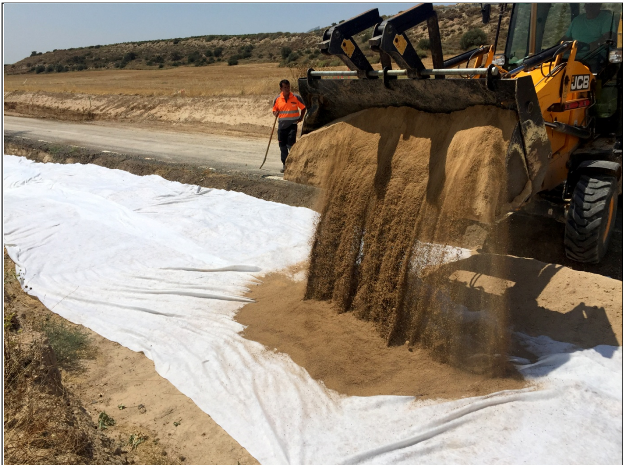
FOTO 17. Vista del procés de cobriment amb sauló de la capa de geotèxtil col·locada inicialment.
