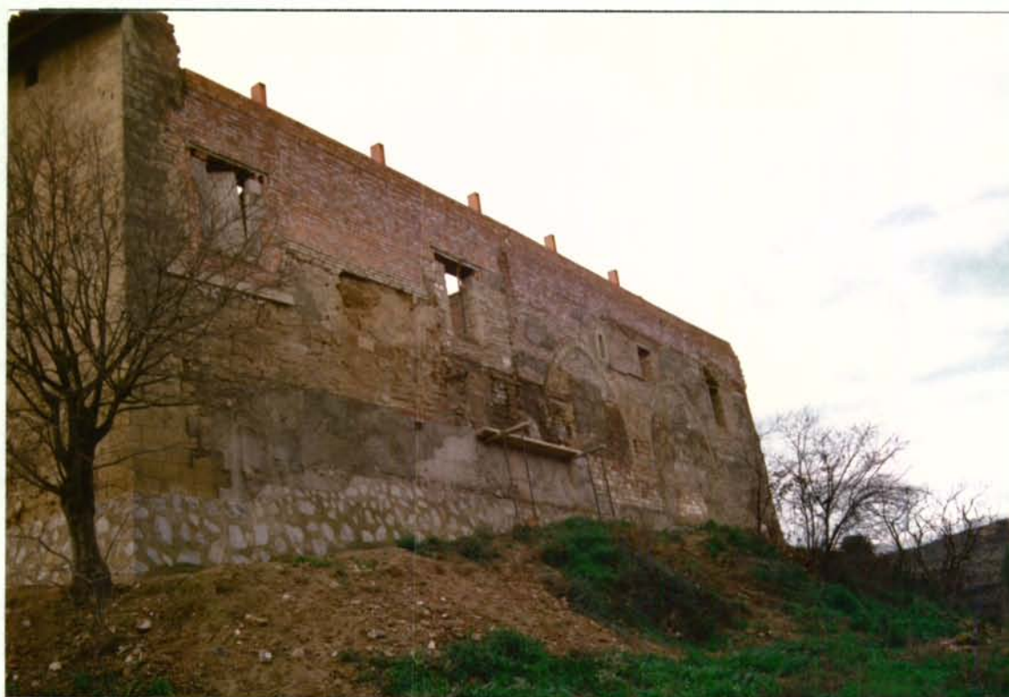
Ilustr. Vista de l'exterior del cos central. Es pot observar fins a quin nivell ha afectat la restauració els paraments de l'edifici.
