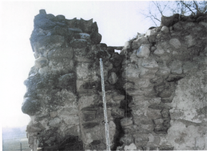
Estat del mur perimetral situat a migdia abans d'iniciar-se les obres, on s'observa la gran esquerda que presentava
