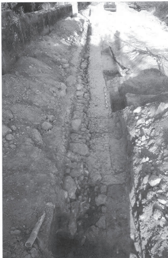
Figura 6. Vista parcial de la vorera de la via romana. Amb un marge modern sobreposat.
