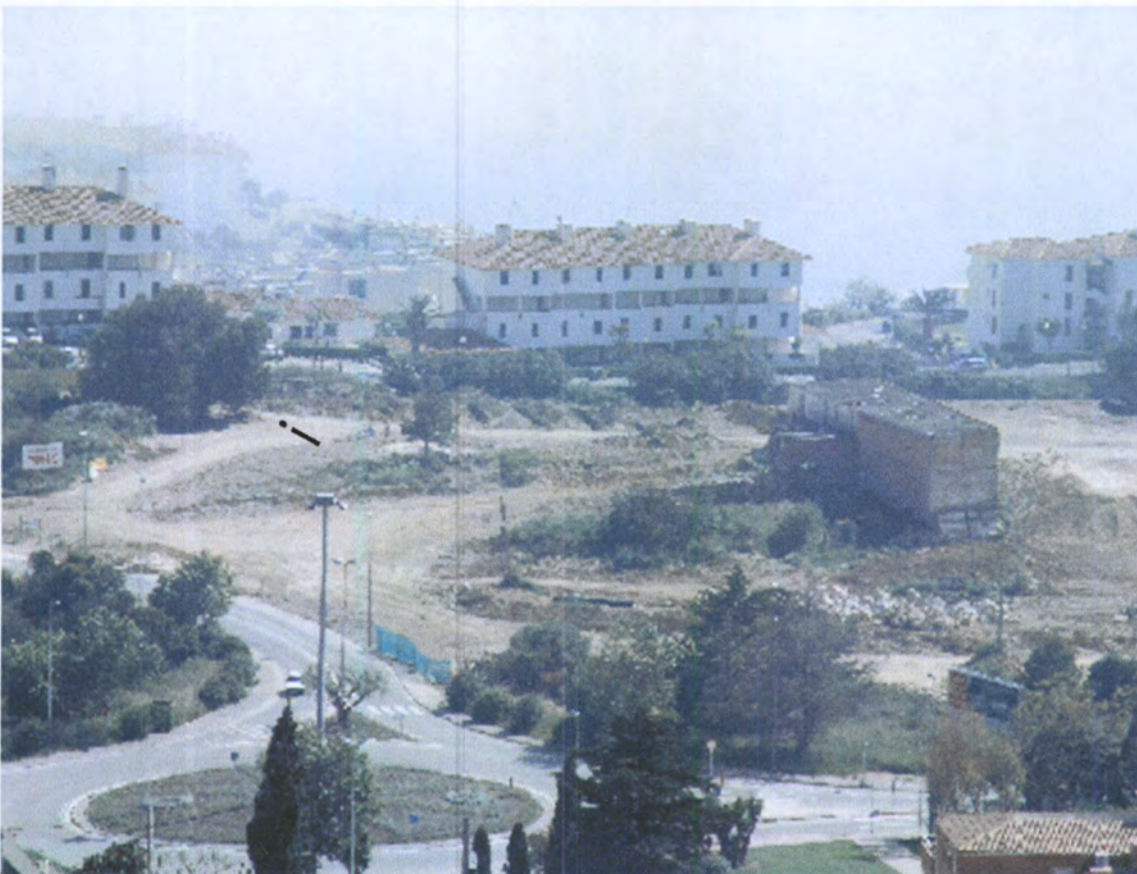
Figura 34. Vista general de la meitat est de l'obra de les Forques. Poden observar-se les rases i el paviment restaurat i protegit.
