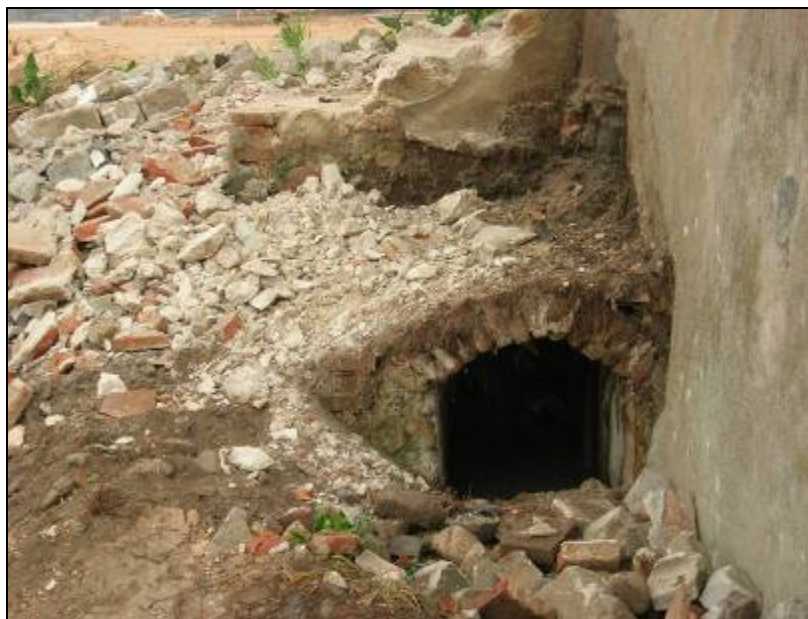
7. Detall del canal de rec sota escales.
