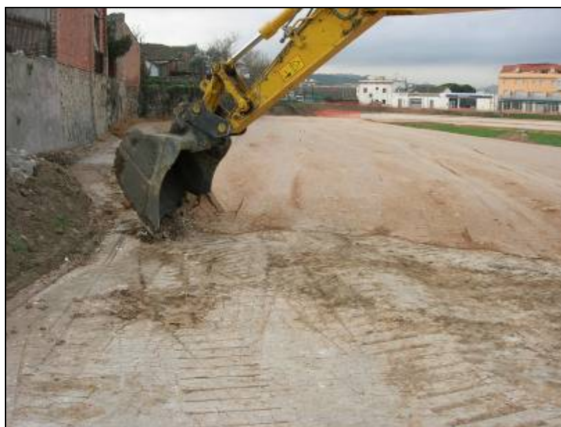
28. Inici dels rebaixos a la zona propera al mur de tanca dins A.P.3 ( Tram 1A).
