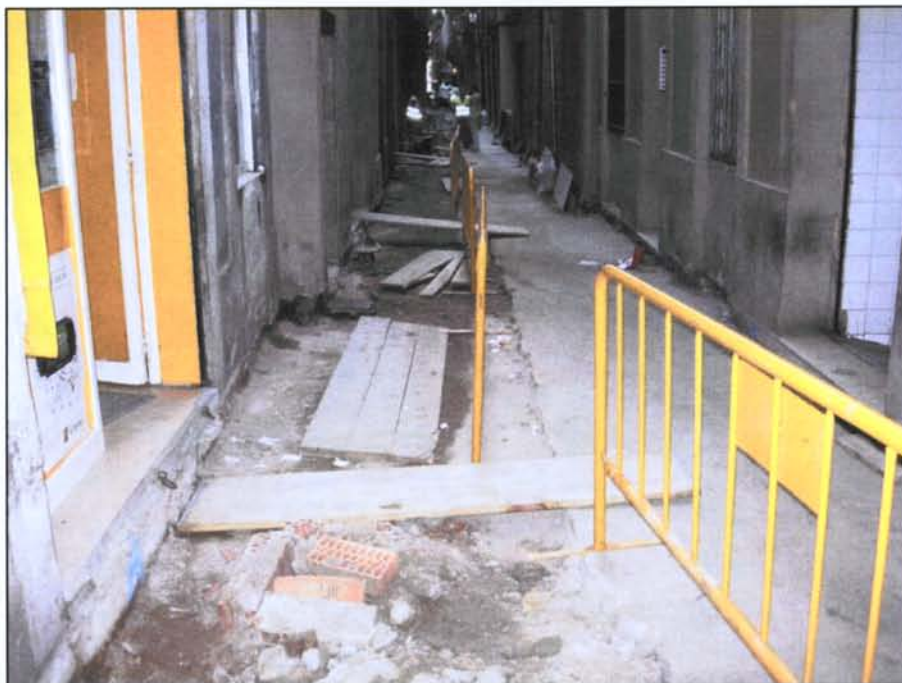
Foto 8: Vista des del nord est del carrer Serra després de l'extracció de les llambordes
