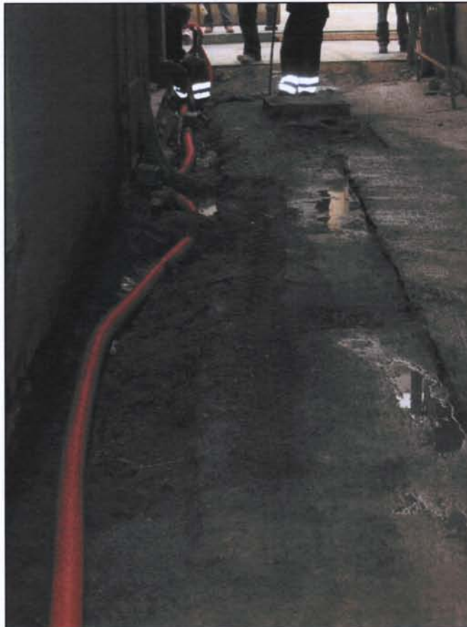
Foto 12: Vista des del nord-est del carrer Còdols durant la instal·lació del nou sistema d'enllumenat
