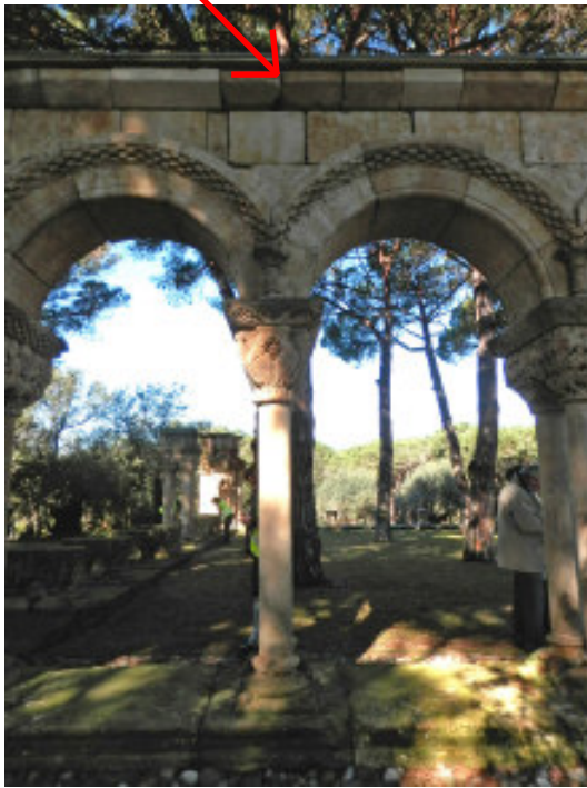
Peça de cornisa trencada al mig: no és una ruptura estructural, sinó que la peça ja estava fracturada en el moment de la seva col·locació.
