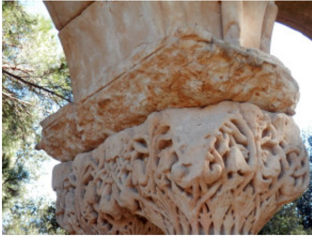
Cantonada de capitell trencada segurament per impacte mecànic i erosionat per el pas de l'aigua.
