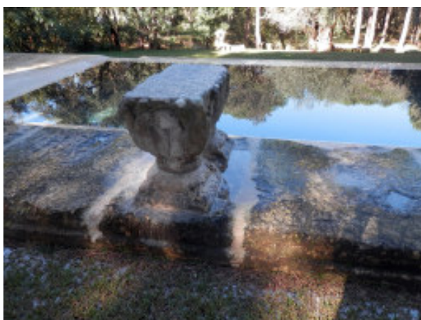
Acumulació d'aigua en el basament del claustre després d'una intensa però curta calamarsada –es veu la calamarsa encara sense fondre-. Aquesta aigua mulla les bases per capillaritat i por assolir el capitell.
