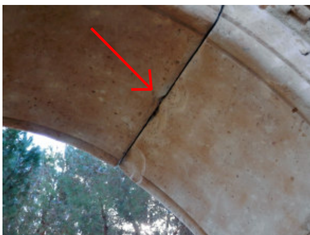
Dovelles afectats per ruptures semi circulars en les vores i cantonades.
