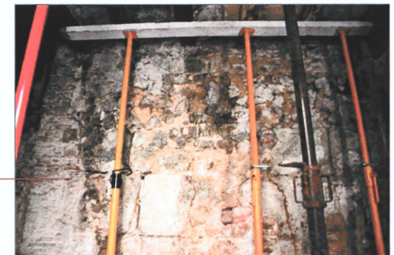
Vista parcial de la zona d'entrega de la torre amb el pany de muralla (vegeu els maons) a l'alçada del pis principal de Regomir
