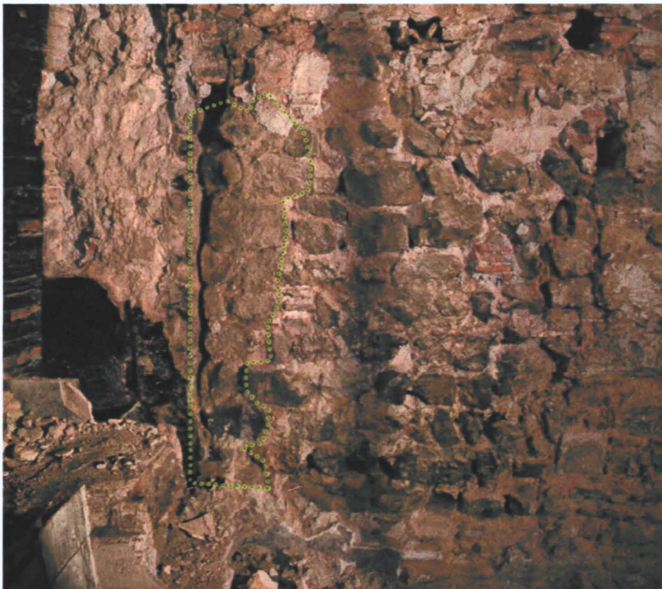
Vista general del parament amb indicació de la zona més antiga; probablement baix medieval. La resta del conjunt és una obra de cronologia contemporània
