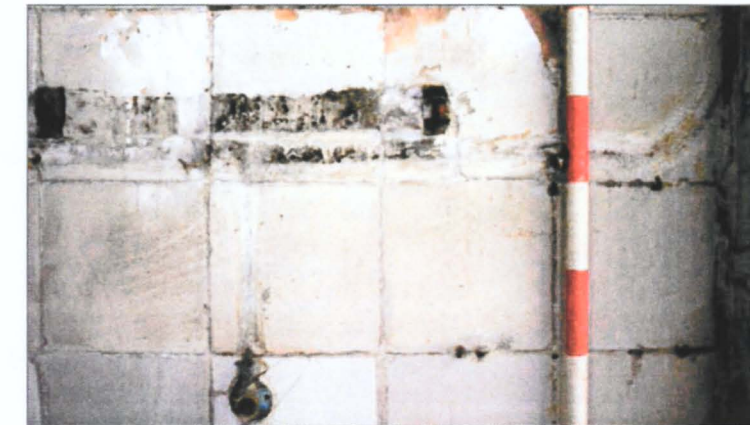
Detall d'una part del revestiment de rajoles a la zona de la paret mitgera
