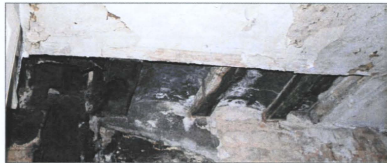
Detall de la zona d'entrega de la campana de fums amb el fals sostre guix. Notem com un cop desmuntada aparegueren les bigues de fusta, el cap de les quals estava totalment malmès
