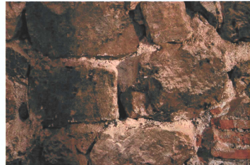
Detall del parament corresponent a l'àrea que mostra morter de calç blanc. Notem la poca cohesió que mostren els elements entre elles, fet que permet deduir que som davant d'una obra menor, no estructural; lligada a alguna actuació de cegat o reforma que datem en base a les informacions documentals cap a 1862
