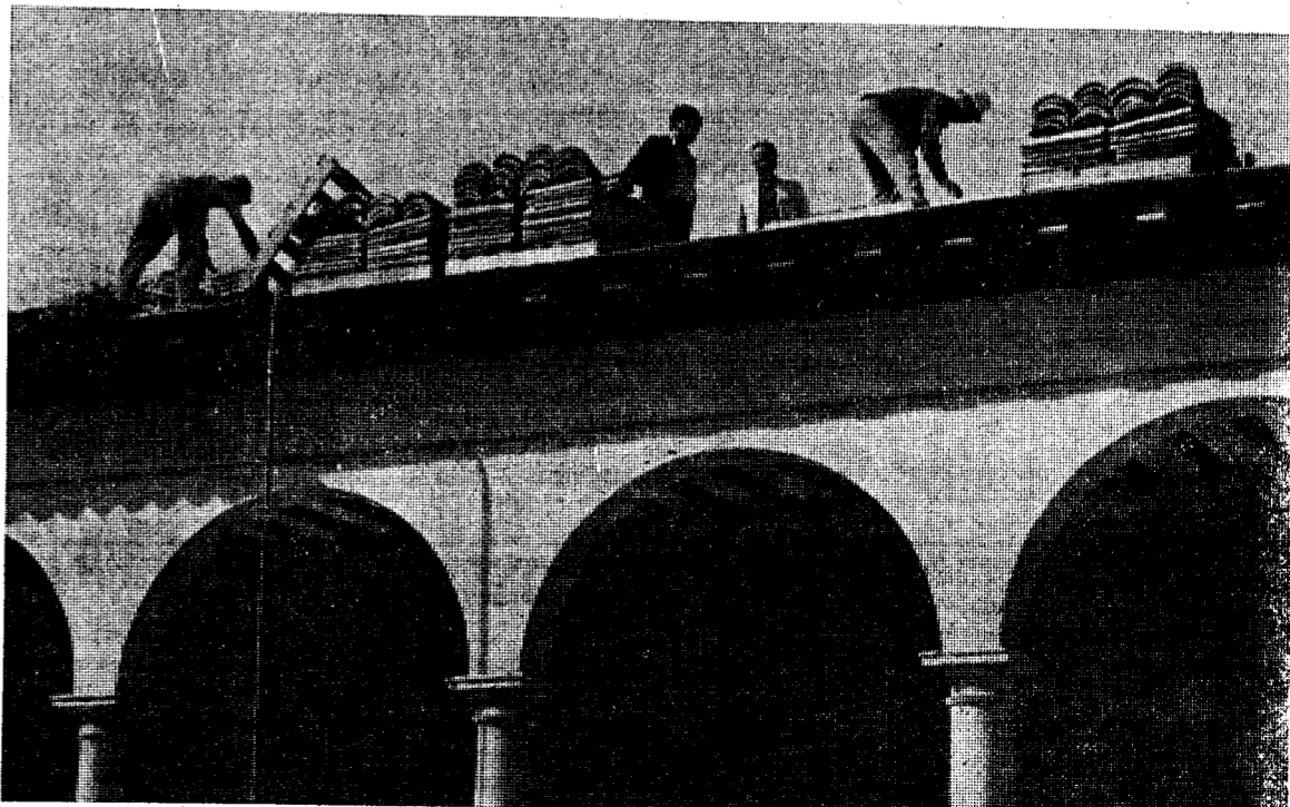
El alcalde, en las obras de derribo de la Loggia. (Foto Pablito).
