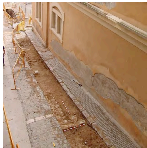
Figura 11. Vista general de la rasa oberta al tram inferior del carrer de Bernat de Fonollar (juliol de 2013), amb la localització del mur ibèric
