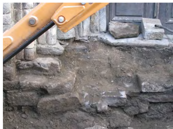
Figura 26. Deuant dera pòrta, s'an redescurbit es antiqes rèstes dera escalinata originau deth temple, causa que mos a permetut ena restauracion, de tornar a recuperar era volumetria originau qu'auie agut en sòn dia aguesta portalada erigida en darrèr quart deth sègle XII.
