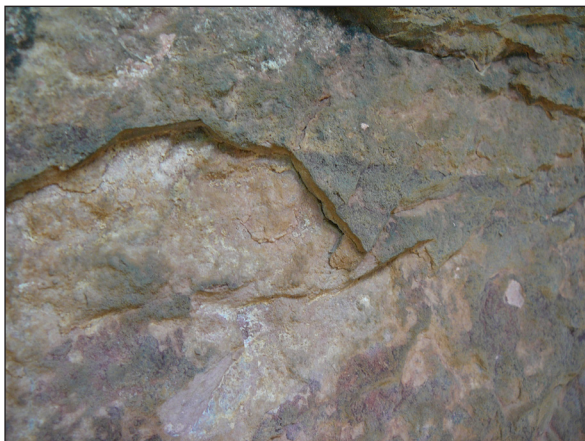
Figura 16. Desplacaments amb pèrdua de pintura i noves fissures.
