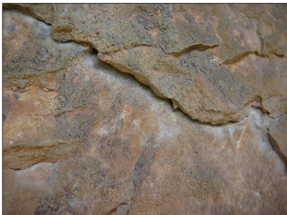
Figura 15. Fissures que amenacen amb futurs desprendiments.
