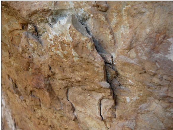
Figura 7. Desplacaments amb risc de caiguda.
