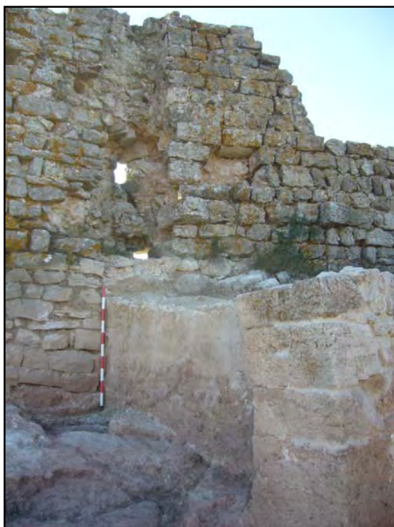
Fig. 9: Extrem sud del mur 777, on s'observa clarament el negatiu que la seva pèrdua a ocasionat en el sí de la muralla, constructivament posterior.
