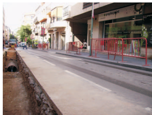
Foto 24. Imatge de la rasa del nou col·lector davant del solar núm. 36, on es localitzà part del paviment 226.
