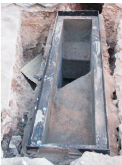
Foto 35. Imatge, des del Nord-oest, del nou caixer que s'ha situat en el Sector 300.
