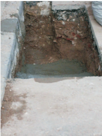
Foto 39. Caixer septentrional, des del sud, del Sector 500, en el decurs dels treballs de construcció de la nova estructura.
