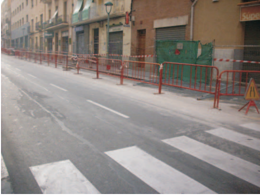
Foto 1. Tram de la rasa col·lector davant els nùms. 7, 9 i 11 del carrer de Maria Cristina, abans de començar els treballs d'excavació.
