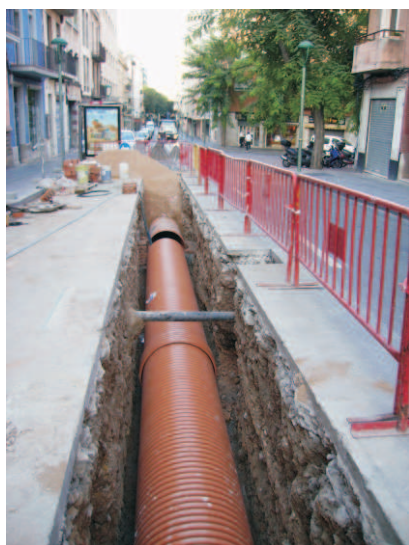
Foto 23. Imatge del nou col·lector del carrer de Maria Cristina, en el tram entre el carrer de Hernández Sanahuja (sota) i l'avinguda de Catalunya (dalt).
