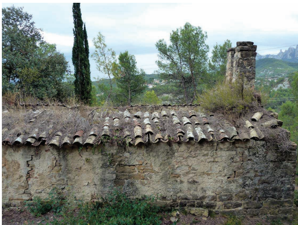
SANT PERE DE VILAMARICS (Monistrol de Montserrat, Bages). - Vista del mur nord de l'església amb les restes de la coberta malmesa. Així mateix, es veu el campanar d'espadanya situat damunt del mur dels peus de la nau, parcialment desmuntat.
