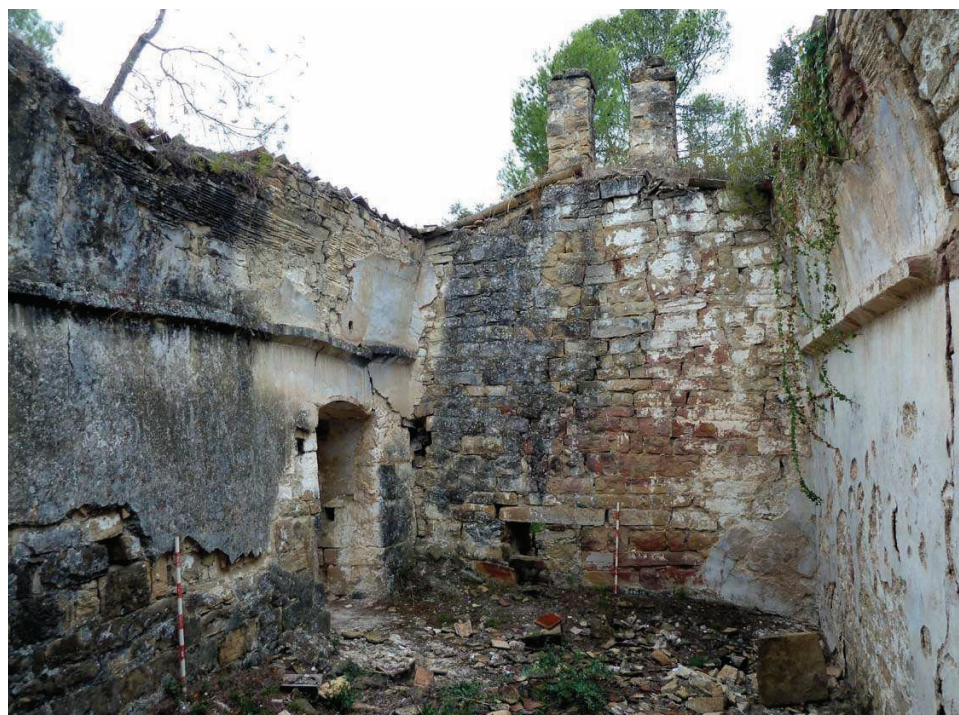
SANT PERE DE VILAMARICS (Monistrol de Montserrat, Bages). - Vista del fons de la nau, on es pot observar les restes d'arrebossat de les parets, el mal estat d'aquestes i la runa que cobreix tota la nau.
