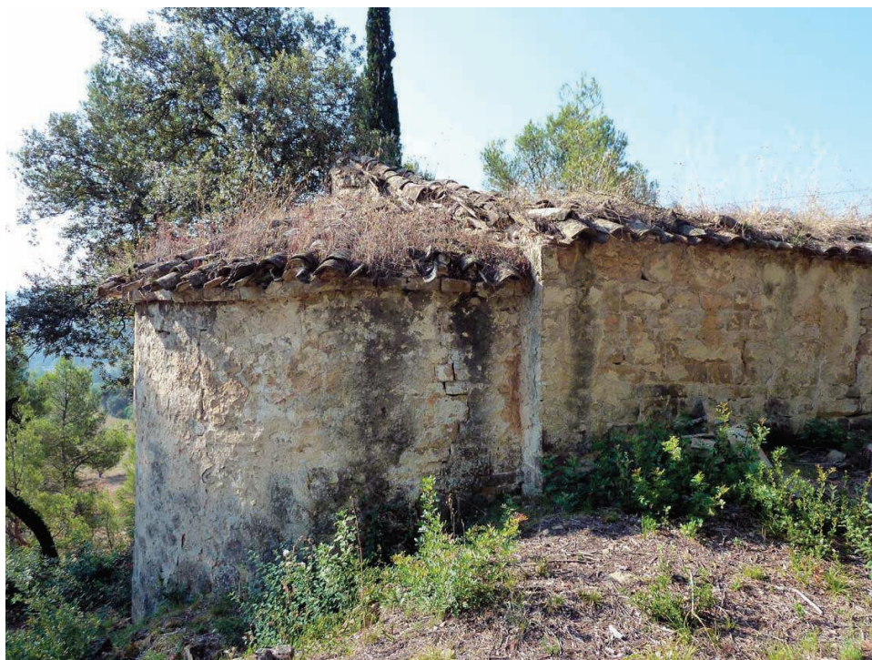
SANT PERE DE VILAMARICS (Monistrol de Montserrat, Bages). - Vista de l'absis semicircular i la nau pel costat de tramuntana. Es pot veure la coberta, afectada per la vegetació.
