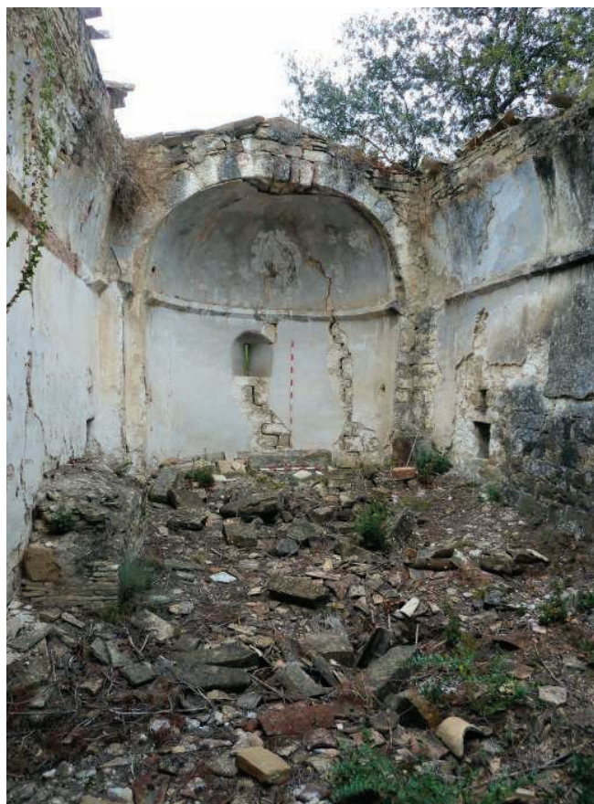
SANT PERE DE VILAMARICS (Monistrol de Montserrat, Bages). - Vista de l'interior de l'església on s'observa l'absència de coberta i la capa de runa interior que hi havia abans de la neteja. Així mateix s'observa el mal estat de conservació de l'absis, amb alguna esquerra.
