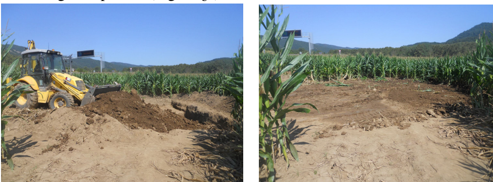
Figura 105. Procés de colmatació del sector K amb retroexcavadora i vista final del sector K una vegada colmatat.
