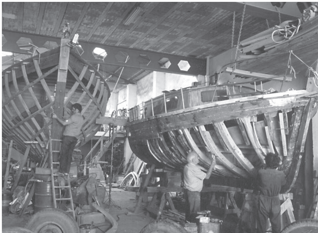
Interior de les Drassanes Gay (Sant Feliu de Guíxols, 1991). Arxiu Municipal de Sant Feliu de Guíxols. Fons Joan i Josep Segur.
