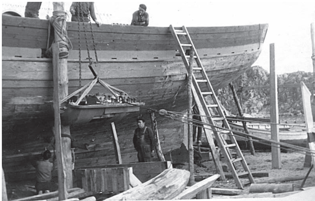
Col·locació d'un motor a un bastiment (Blanes). Arxiu Municipal de Blanes. Col·lecció Joaquim Malvesí.
