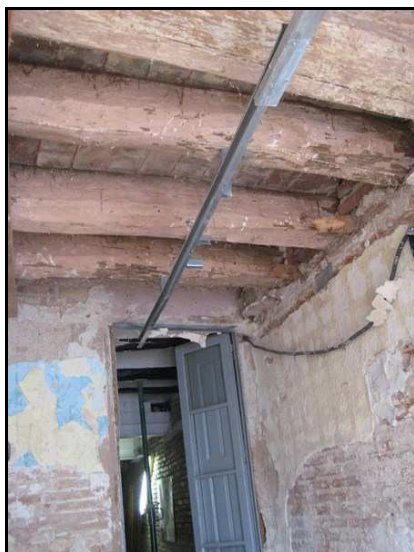
Imatge del sostre i parets del segon àmbit
