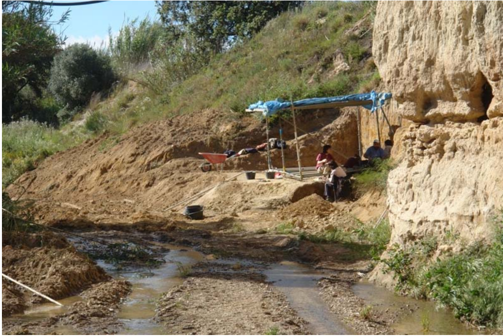
Figura 8.-Muntatge de les envestides per tal protegir la superfície d'excavació de la Mina.
