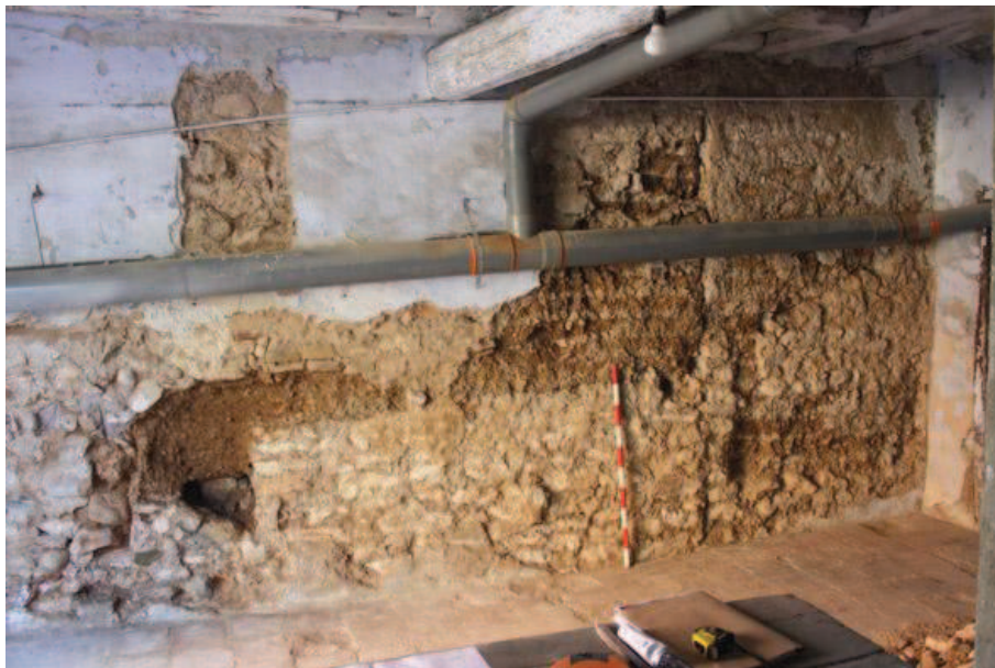
7-Vista parcial del mur EM1, obrat en tàpia, els seus sòcols i arranjaments posteriors
