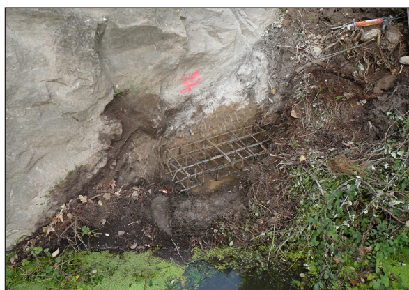
Figures 21 i 22. Fonamentació de pilars i sabata especial del pilar número 3, entre la roca i el canal d'Anyà.
