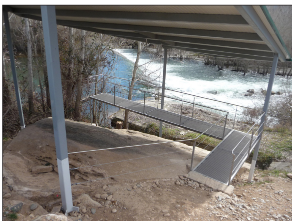
Figura 27. Passera ja instal·lada i barana de conducció de la visita. Es poden observar els tirants que subjecten la passera al sostre de l'estructura.
