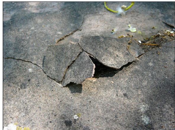
Figura 8. Exfoliacions i desplaçaments són el resultat final dels processos de meteorització.
