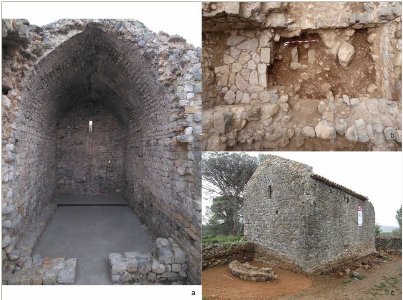
Figura 2. A, Fotografia de l'interior de la nau un cop finalitzats els treballs d'adequació, B, Fotografia zenital de la galilea. C, Fotografia de la part posterior de l'església amb l'absis romànic en primer terme.
