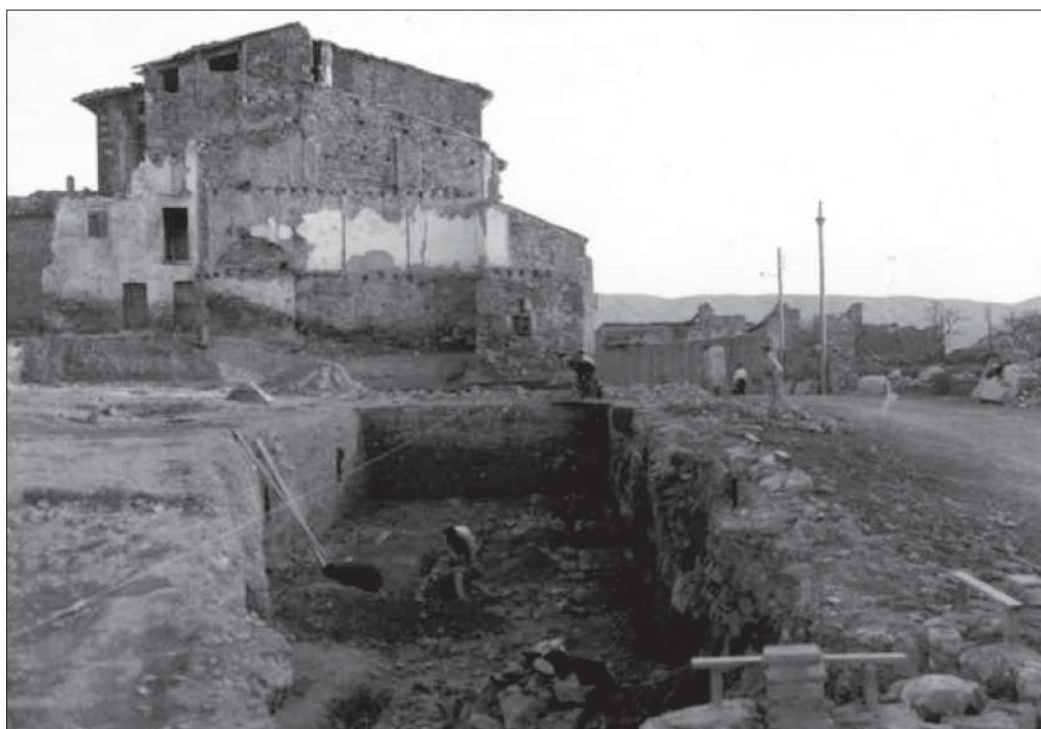
Figura 7. Treballs de fonamentació del solar entre la plaça del Bisbe Badia i el carrer de Sant Jaume, l'any 1943 (Font: AHL - Regiones Devastadas 260-18-N-64).
