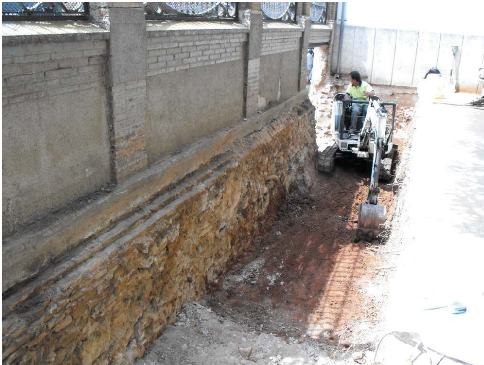
C. DE LA INDÚSTRIA, 9 (Sabadell, Vallès Occ.).- Vista dels treballs d'obertura de la cala. S'observa el terreny natural d'argiles carbonatades que aflora al fons de la cala, per sota el nivell de terra i runa de reblliment superior.
