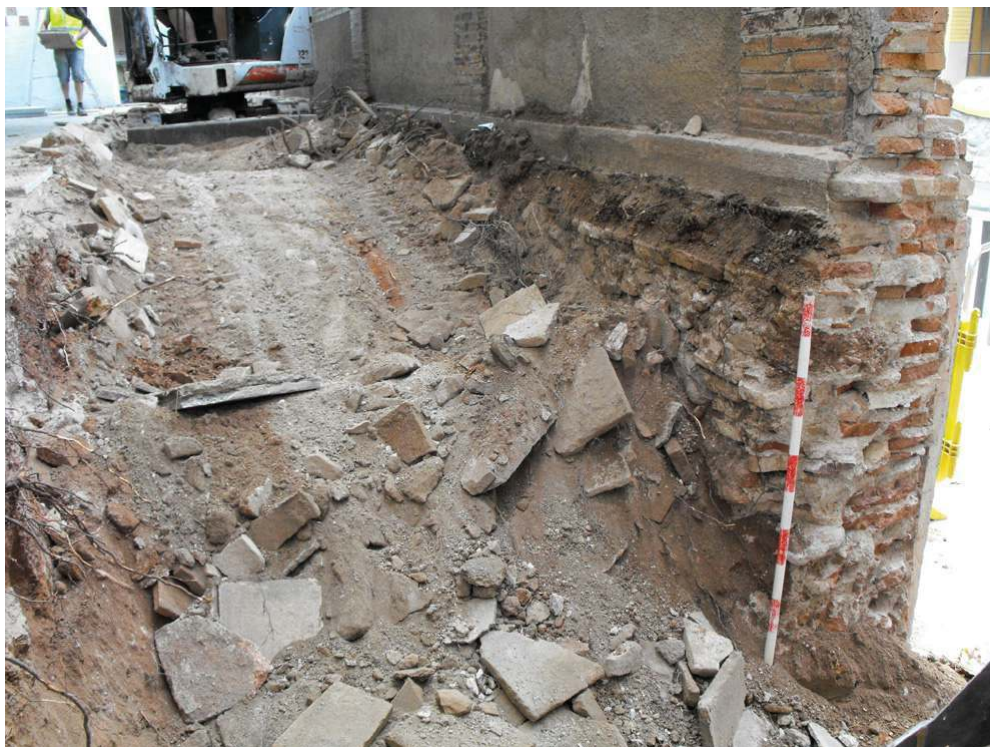
C. DE LA INDÚSTRIA, 9 (Sabadell, Vallès Occ.). - Vista durant el desenvolupament de les obres, on observem la fonamentació de la tanca modernista del col·legi, des de l'oest, i el nivell de terra i runa de l'interior del pati.
