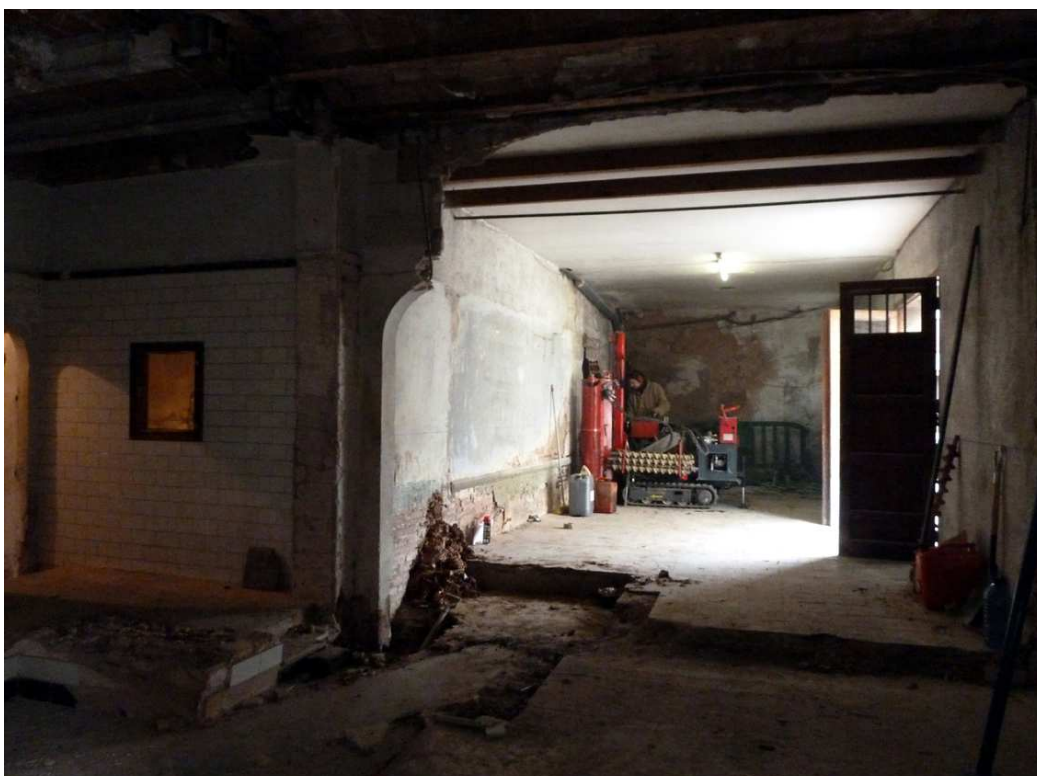
C/ CREUETA, 57 (Sabadell, Vallès Occ.). -Vista de l'indret a on s'han realitzat les cales de reforç, a banda i banda del mur de l'esquerra.
