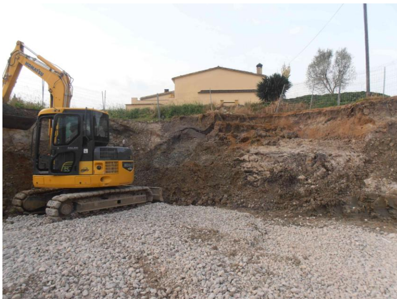
Fig. 3. Vista de l'esllavissament de la paret sud-est
