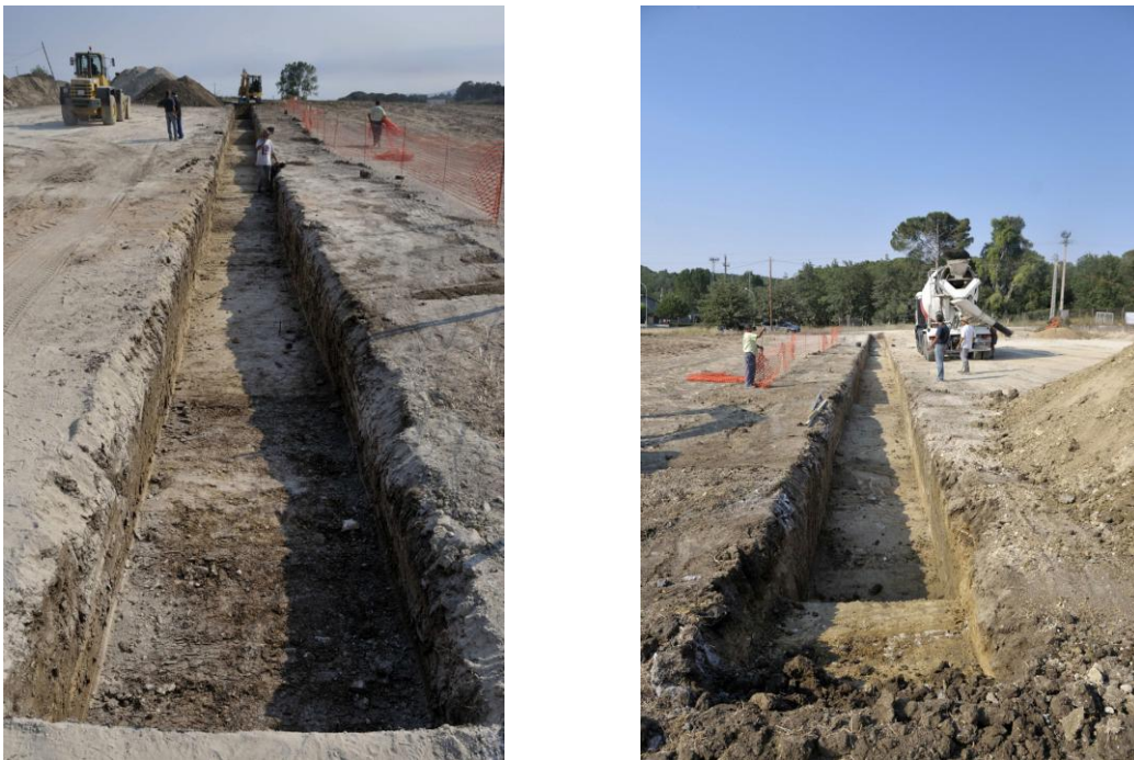
Fig. 3. Vista general de la rasa de fonamentació del sector oest del sector comercial. No ha aparegut restes paleontològiques ni paleobotàniques.
