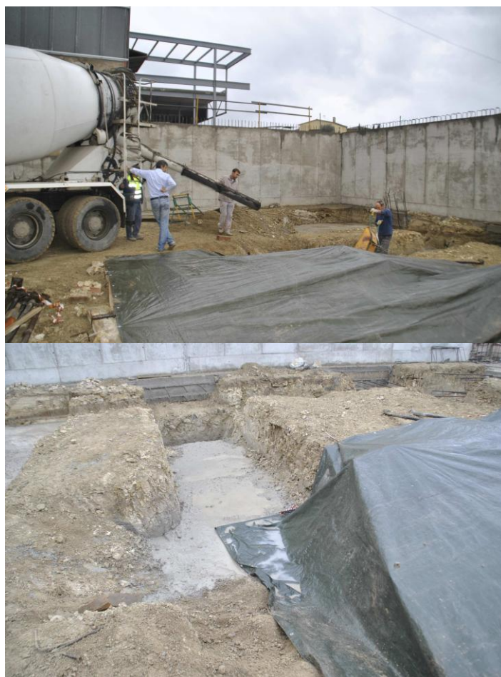
Fig. 18. Vista del reompliment de formigó del pou del bòvid 7 i detall del toldo de protecció de l'àrea d'excavació del bòvid 9.
