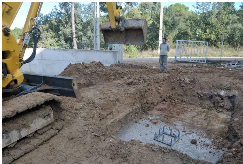
Fig. 24. Seguiment de màquina per a la realització d'un rebaix en un dels límits del centre comercial
