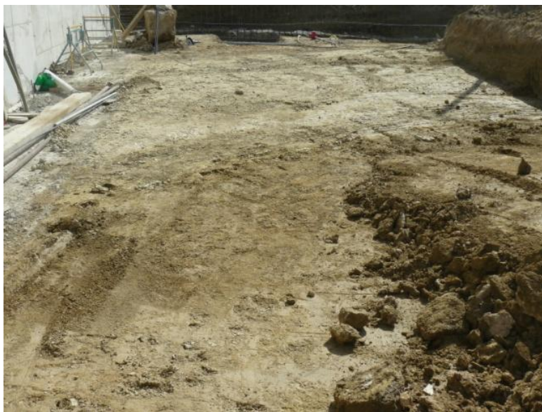
Fig 15. Imatge del rebaix i del perímetre de seguretat per a realitzar excavació de les restes.
