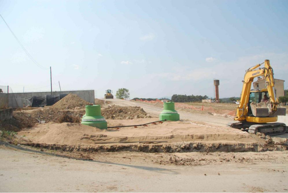
Fig 6. Excavació de la rasa, al fons es veu el mur de formigó on ha d'anar ajuntar-se.
