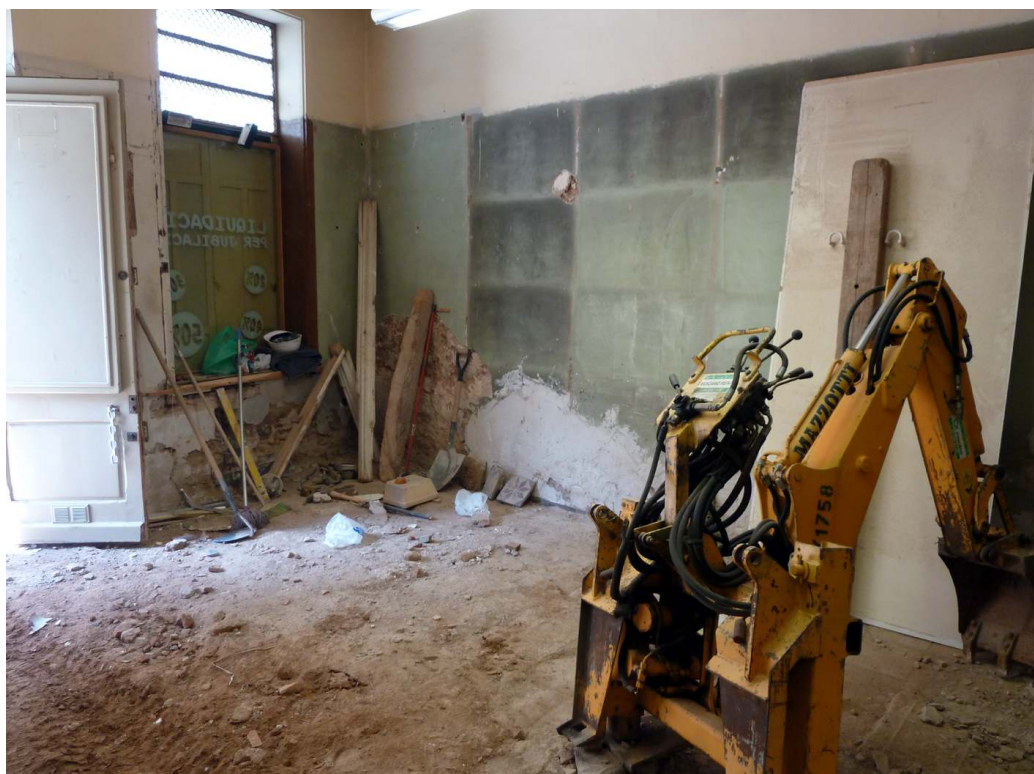
C/ SANT FELIU, 9 (Sabadell, Vallès Occ.).- Vista de l'entrada on es pot veure la capa de morter de calç de preparació de l'enrajolat, aquí ja desmuntat.
