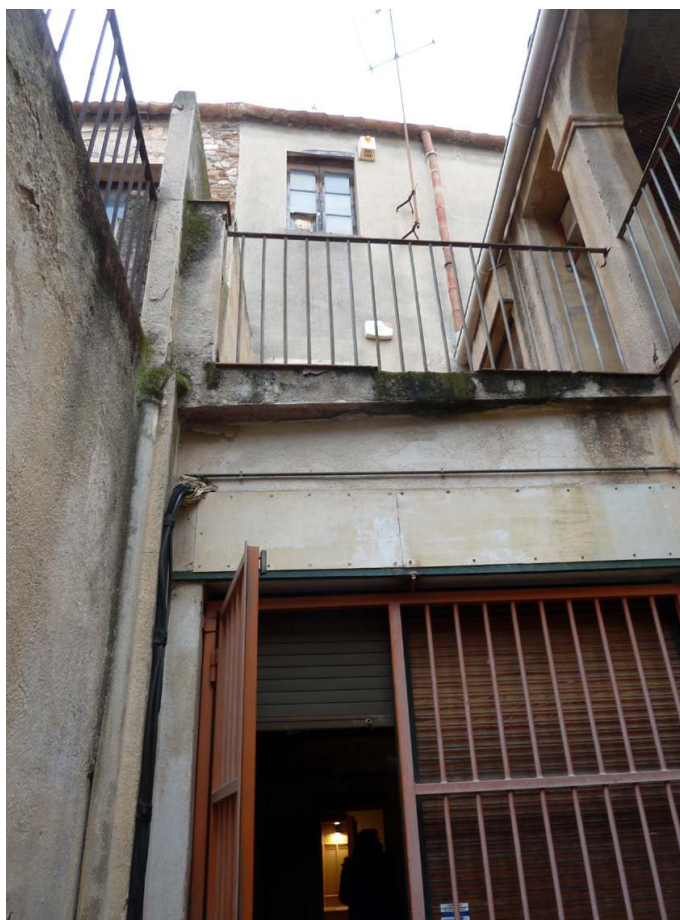
C/ SANT FELIU, 9 (Sabadell, Vallès Occ.). - Vista de la façana posterior de l'edifici, on es pot veure un terrat al primer pis que dóna accés a un cos lateral construït. Aquestes estructures varen ser enderrocades.
