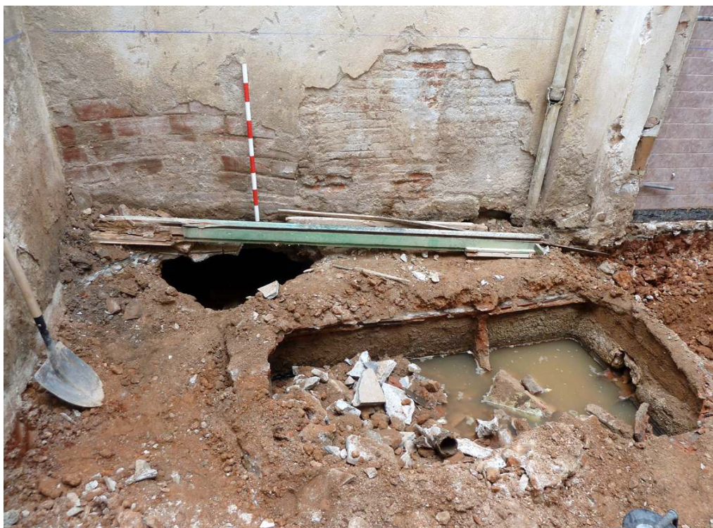
C/ SANT FELIU, 9 (Sabadell, Vallès Occ.).- Vista d'una fossa sèptica en ús fins a l'actualitat i un pou mort situat a sota de la paret mitgera de separació amb la finca veïna a la zona del pati.
