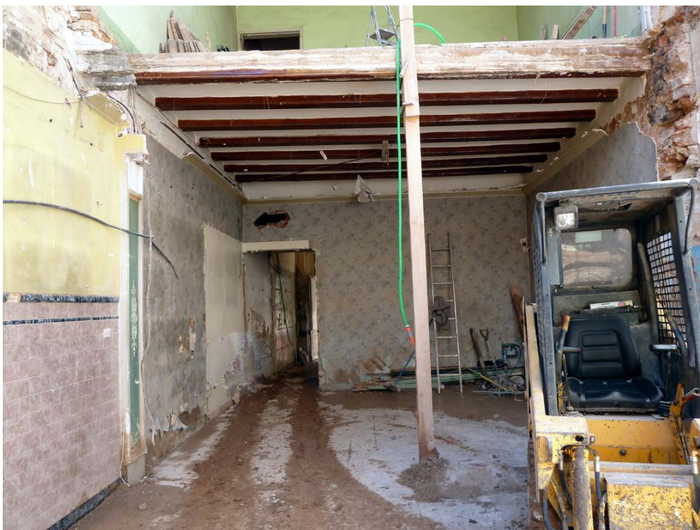
C/ SANT FELIU, 9 (Sabadell, Vallès Occ.).- Vistes dels treballs de control arqueològic dels rebaixos efectuats a la planta baixa. S'ha localitzat el terreny natural d'argiles plàstiques per sota de l'enrajolat d'època contemporània, ja rebaixat d'antic.
