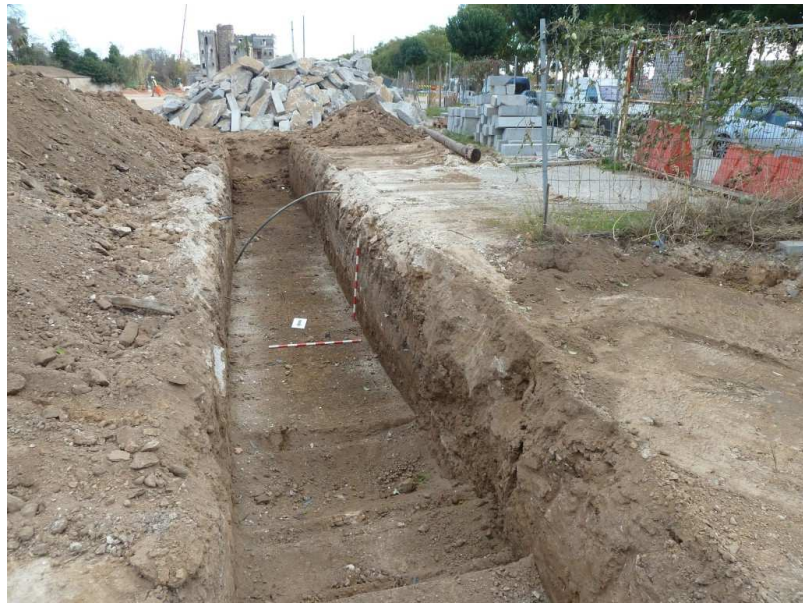
AV. DEL SOL, CAMÍ DEL MIG, CAN CODINA (Sant Joan Despí, Baix Llobregat). - Vista de la Rasa 4, que discorre paral·lela al Camí del mig i transversal a la 1, 2 i 3. Al fons es pot veure la masia de Cal Felip.
