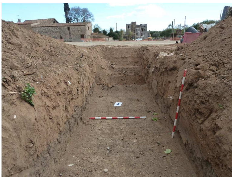
Detall de la Rasa 6, situada al cantó oest del solar. Al fons es poden veure les masies de Can Codina i Cal Felip. No es va localitzar cap tipus de resta arqueològica.
