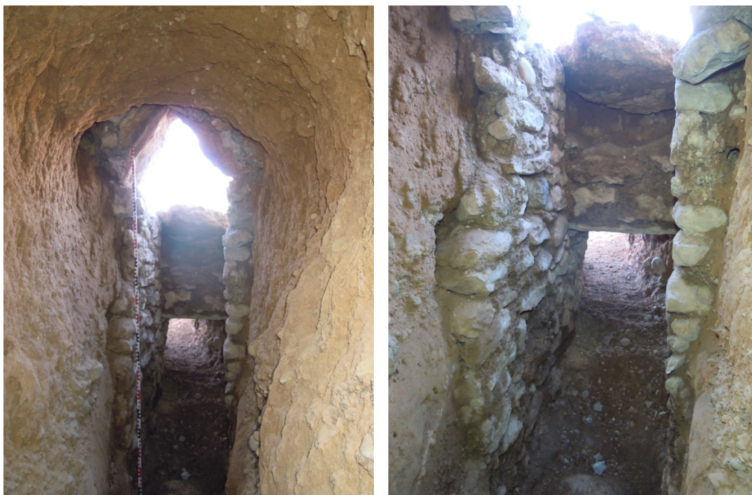
35, 36. Vista des del tram situat sota la finca veïna de la mina UE 16, amb el reforç a la zona de traspàs de la muralla i l'estructura de registre, amb una llosa de la coberta conservada.
