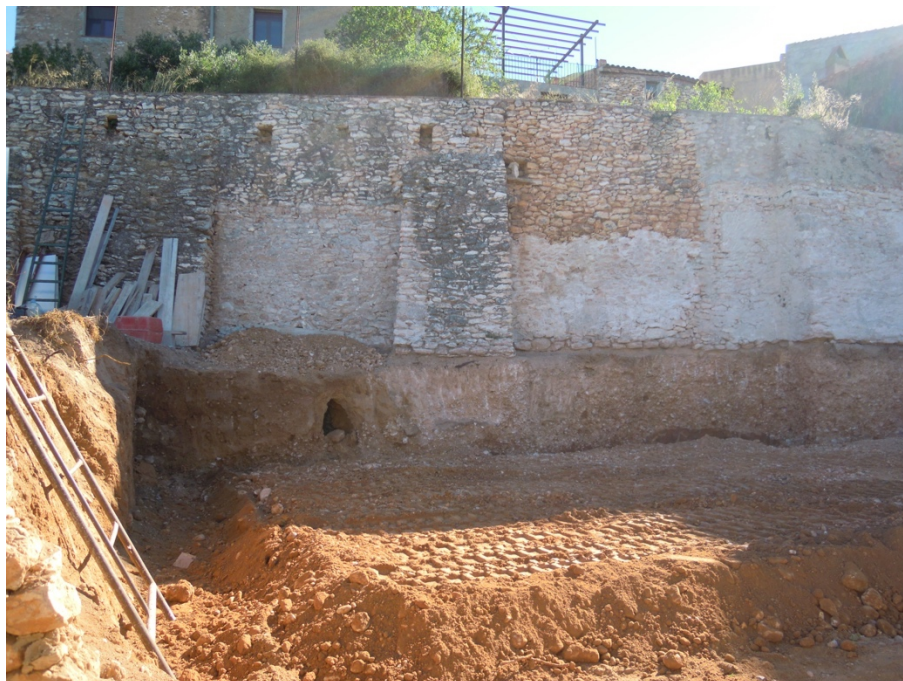
60. Vista general del sector septentrional i central de l'àrea d'actuació, un cop finalitzats el rebaix i les deconstruccions previstes.
