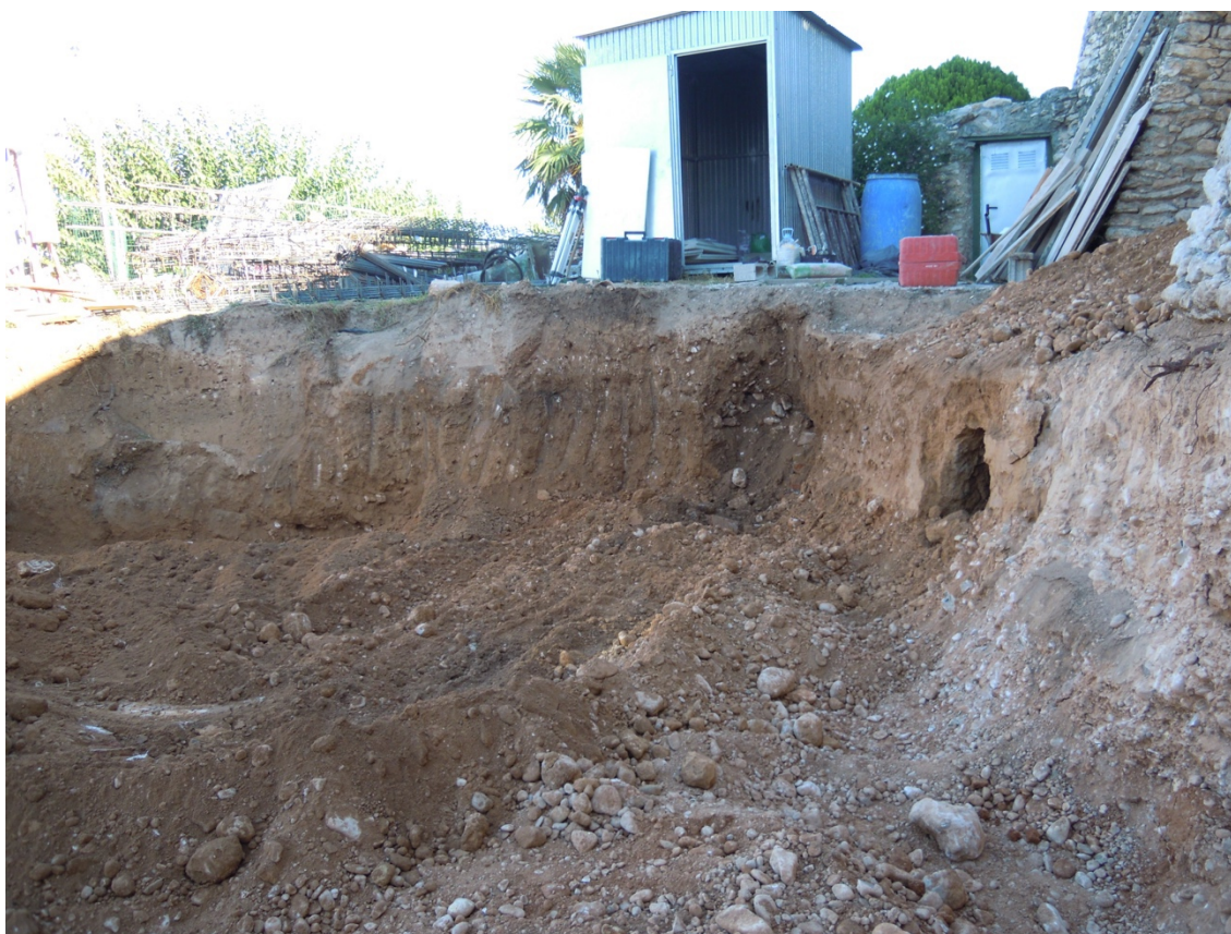
58. Detall del frontal de la zona d'actuació a l'extrem nord, un cop finalitzat arribats al final del rebaix.
