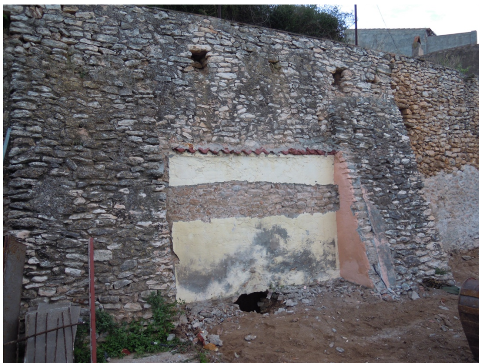
20. Detall de la barraca d'eines un cop enderrocada, on es va localitzar una obertura a la base de la muralla que permeté l'accés a una mina d'aigua excavada al subsol i codificada com UE 16.
