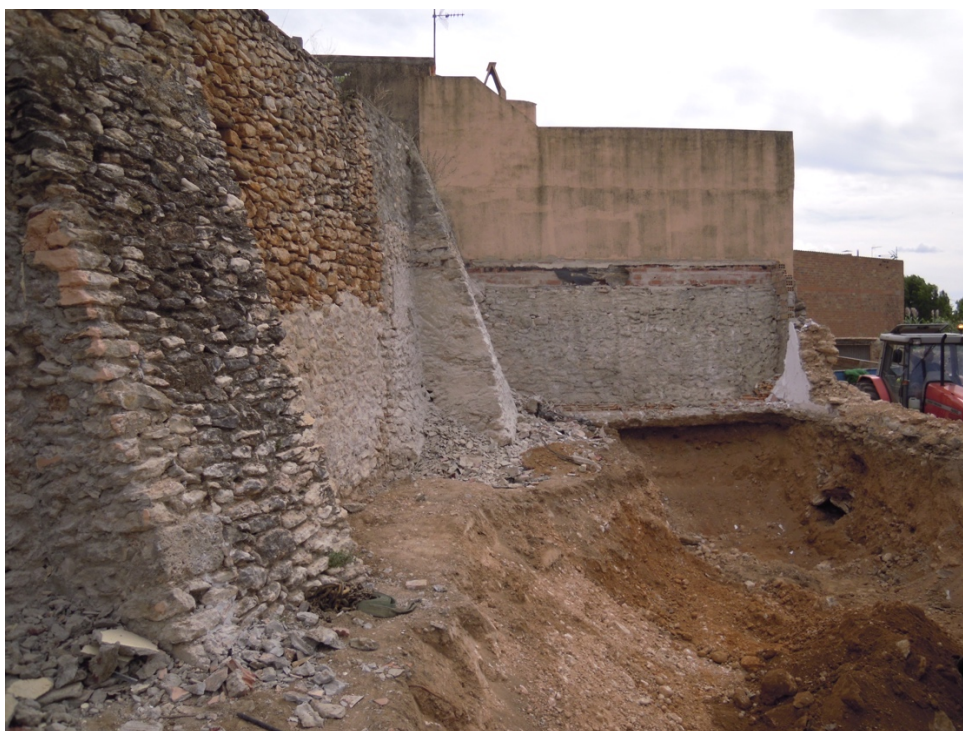
27. Vista general de la zona rebaixada en un moment avançat dels treballs mecànics. A l'esquerra es pot veure l'alçada del substrat argilós UE 15, on recolza la base de la muralla, i a la dreta el perfil de la mina UE 18.
