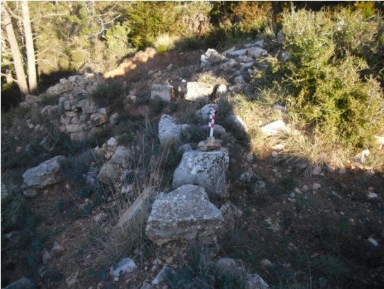
MR 1007 previ a la consolidació
