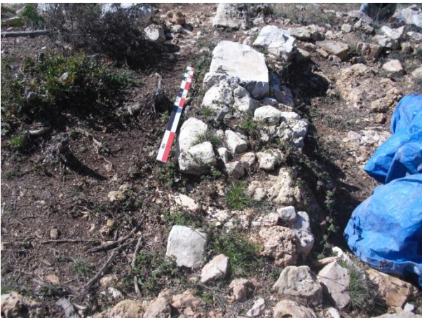
MR 1002 previ a la consolidació
