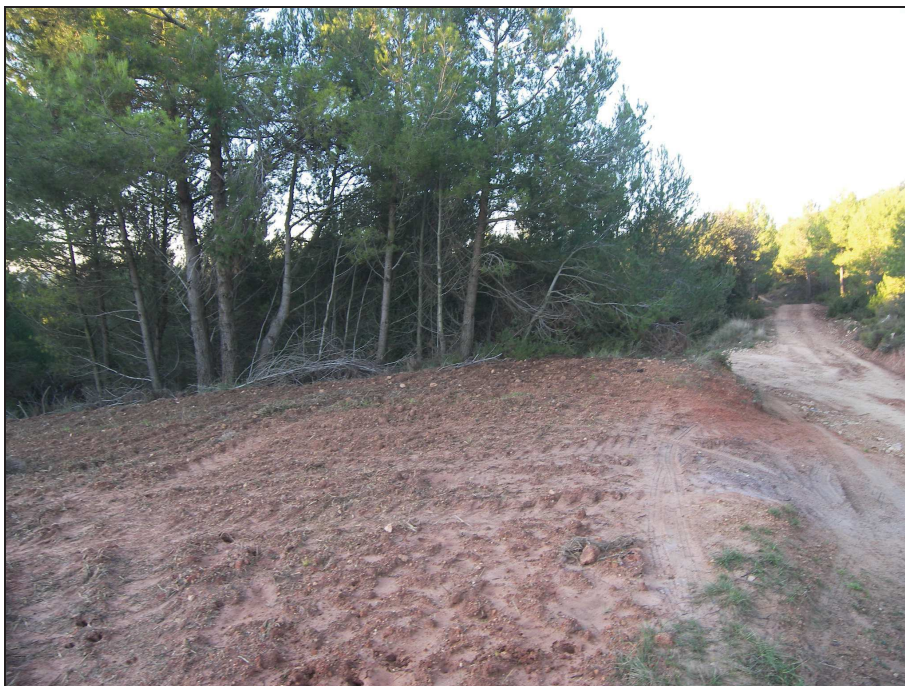
Foto superior : Emplaçament de la subestació on s'inicia la línia elèctrica d'evacuació.
