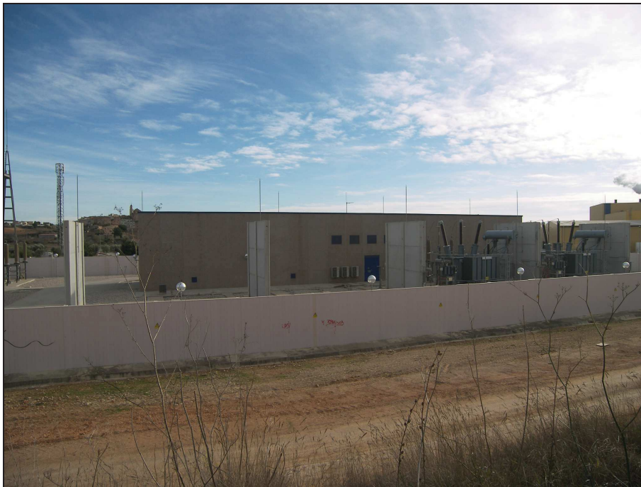
Foto superior : Emplaçament de la torre 85, amb la subestació elèctrica final de la línia en primer pla a la dreta i el nucli de Puigpelat al fons a l'esquerra. Foto inferior : La subestació final de la línia elèctrica d'evacuació.
