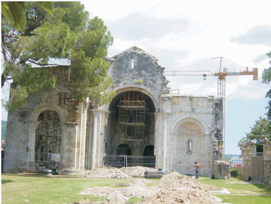
Vista general de l'excavació. Al fons, la capçalera de Santa Maria durant les obres de consolidació.
