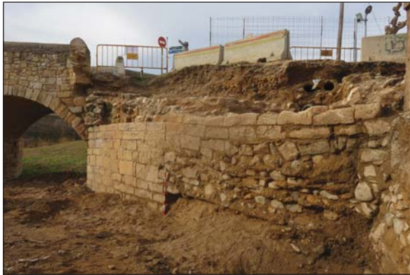
Fig. 6. Vista del tram final del mur del pont que travava l'estructura amb la riba i que en la part inferior no era visible.
