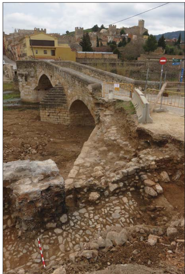
Fig. 5. Vista de l'estrep original del pont amb les restes del paviment d'accés.
