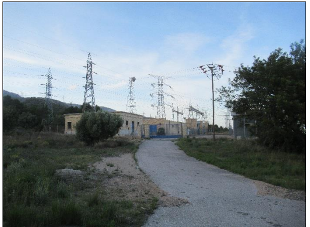
FOTO 76. Instal·lacions actuals de la SET Vandellós.
