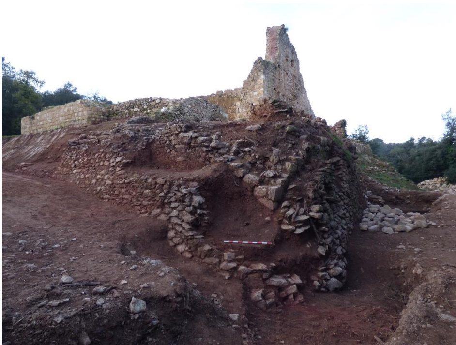
Foto 19: Detall de l'angle nord-est del castell. Es poden observar les diferents fases constructives d'aquesta zona del castell.
