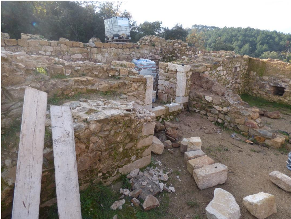
Foto 27: Treballs de preparació per a la reconstrucció de l'escala del pati interior.
