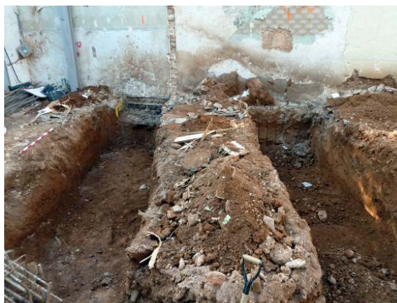
Vista de les rases 1 (dreta) i 4 (esquerra), efectuades al solar i a on no es va documentar cap resta arqueològica. El terreny natural apareixia just per sota el nivell d'enderroc.
