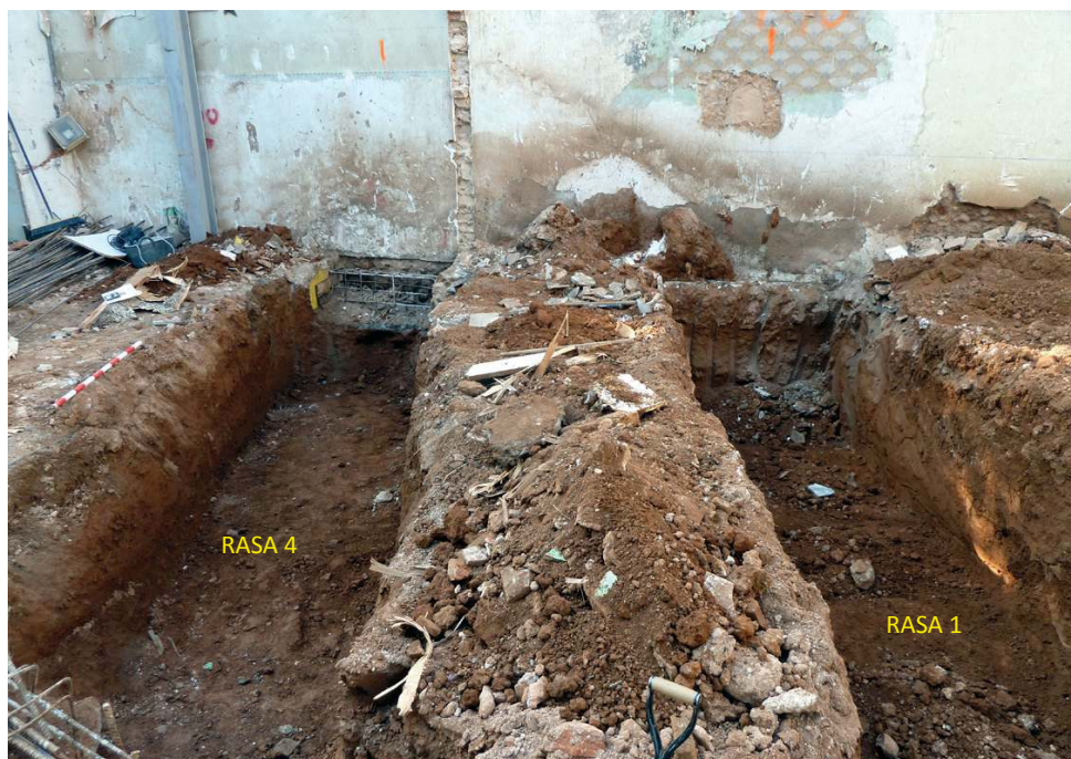
PLAÇA MARQUILLES, 1 (Sabadell, Vallès Occ.) .- Vista de la Rasa 1 i la Rasa 4, excavades al terreny natural al centre del solar amb una direcció nord – sud. Sense presència de restes arqueològiques.
