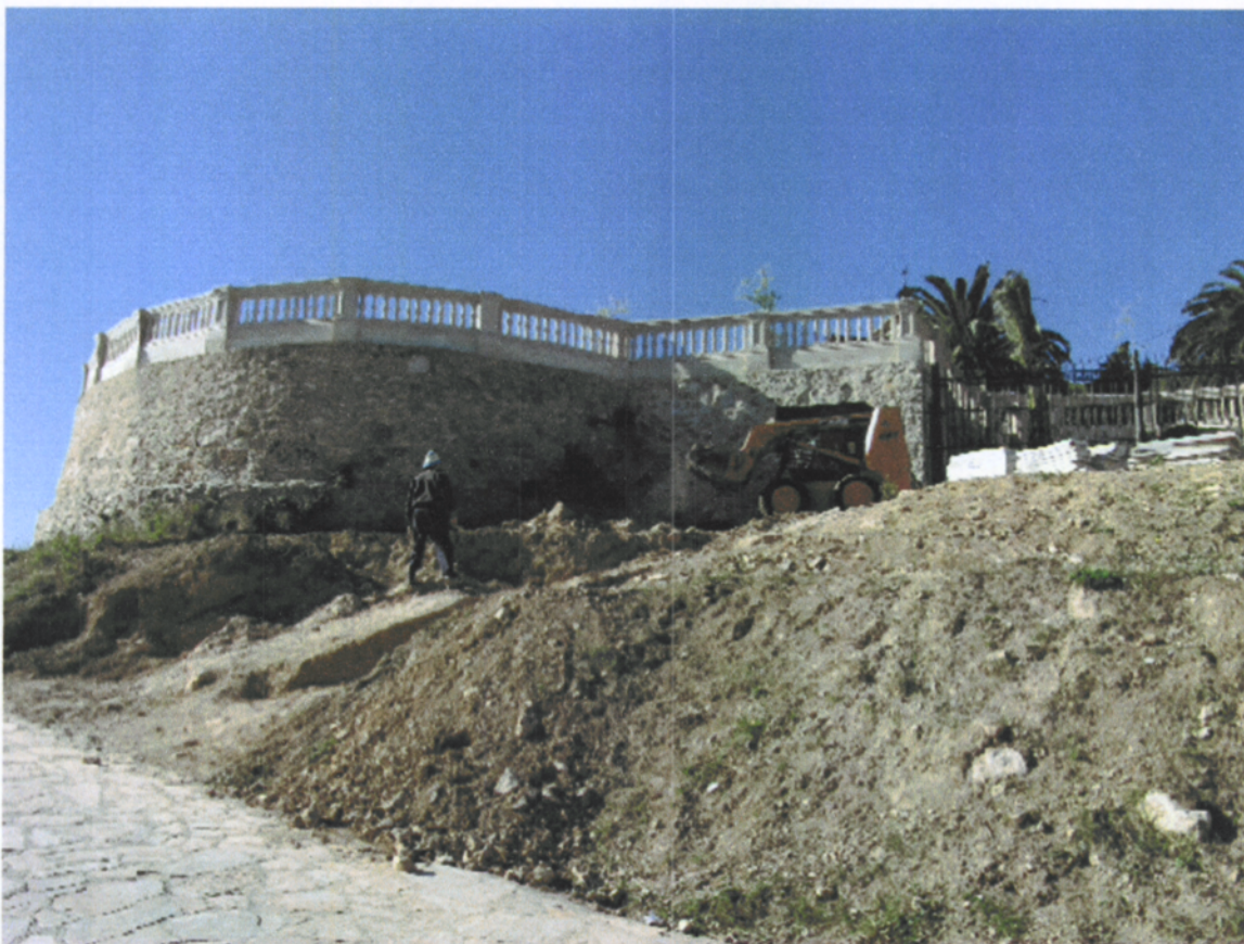
Figura 9. Vista general de la zona d'accès al Xalet del Nin. Treballs d'excavació
