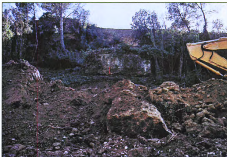
Zona de la pedrera afectada per les obres.
