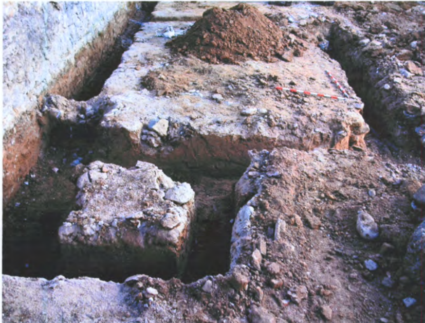
C/ ST. JOSEP 21-23 (Sta. Perpètua de Mogoda) – Vista del costat oest del solar amb les rases de sondeig arqueològic. S'observa la presència de runa producte de l'enderroc i el nivell d'argila plàstica del terreny natural, sense cap tipus de vestigi arqueològic.
