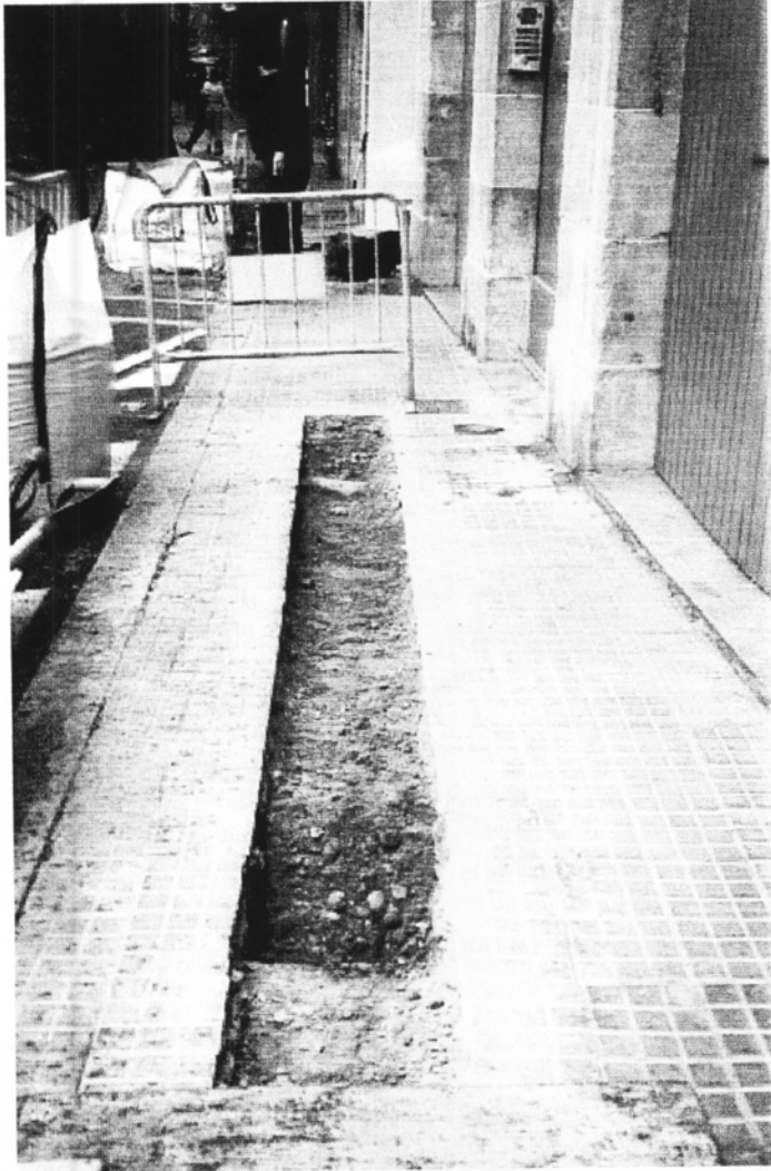
Imatge 5. Vista del tram final de la rasa una vegada extret el paviment
