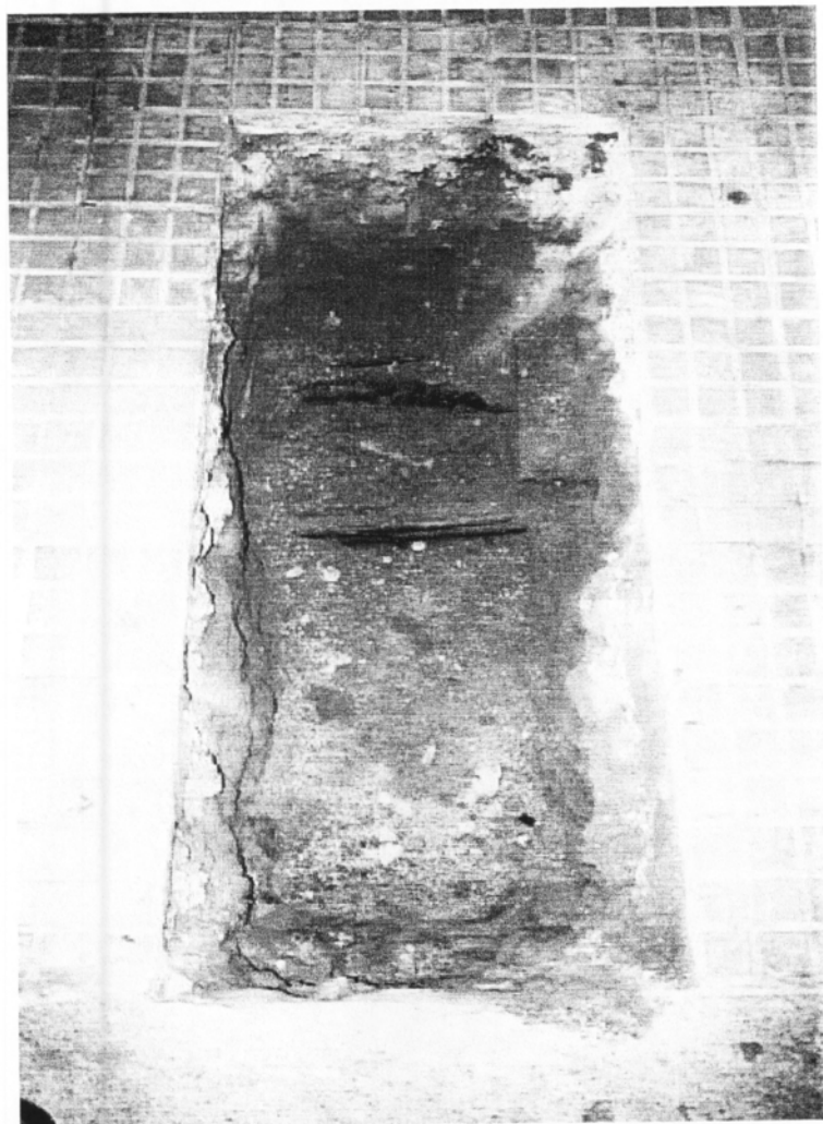
Imatge 2. Vista de la cala oberta abans d'excavar la rasa del carrer Ramelleres
