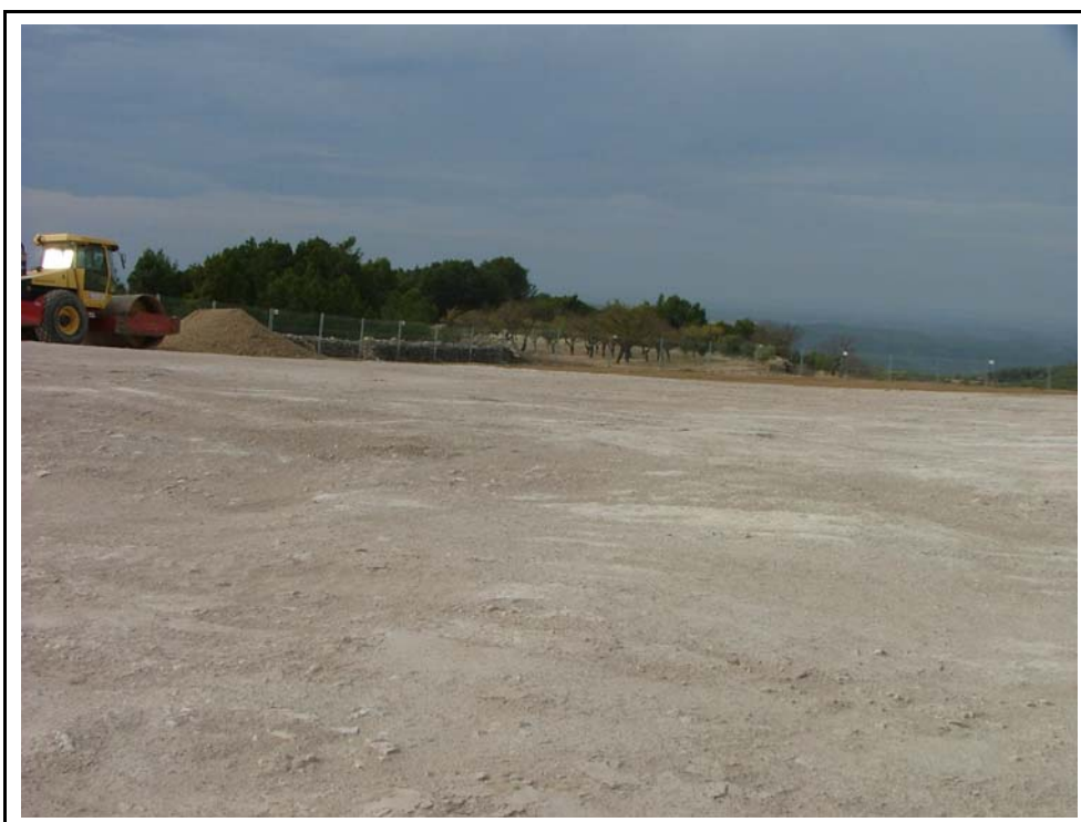
Foto 10. Vista general de la zona d'ubicació de la subestació.
