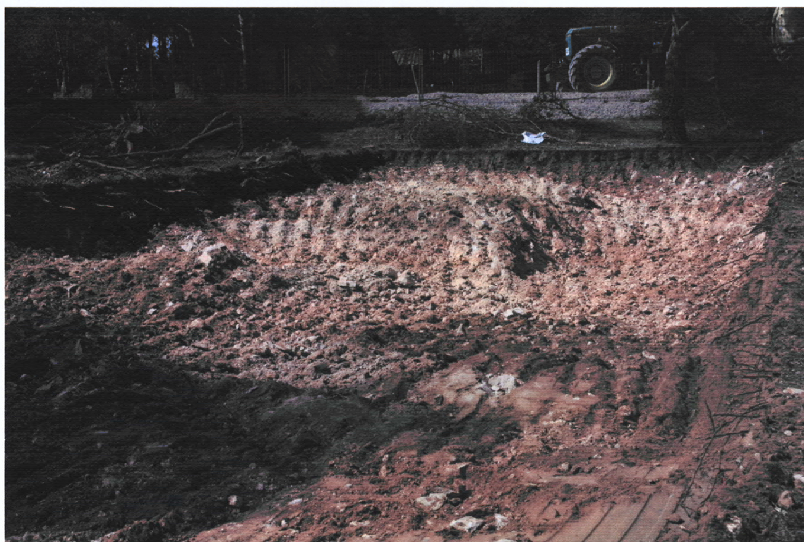
Figs. 3 i 4. Detalls del rebaix de les terres i del subsòl per a la construcció de la vivenda situada al carrer Puig i Cadafalch 52 del municipi de l'Escala.
