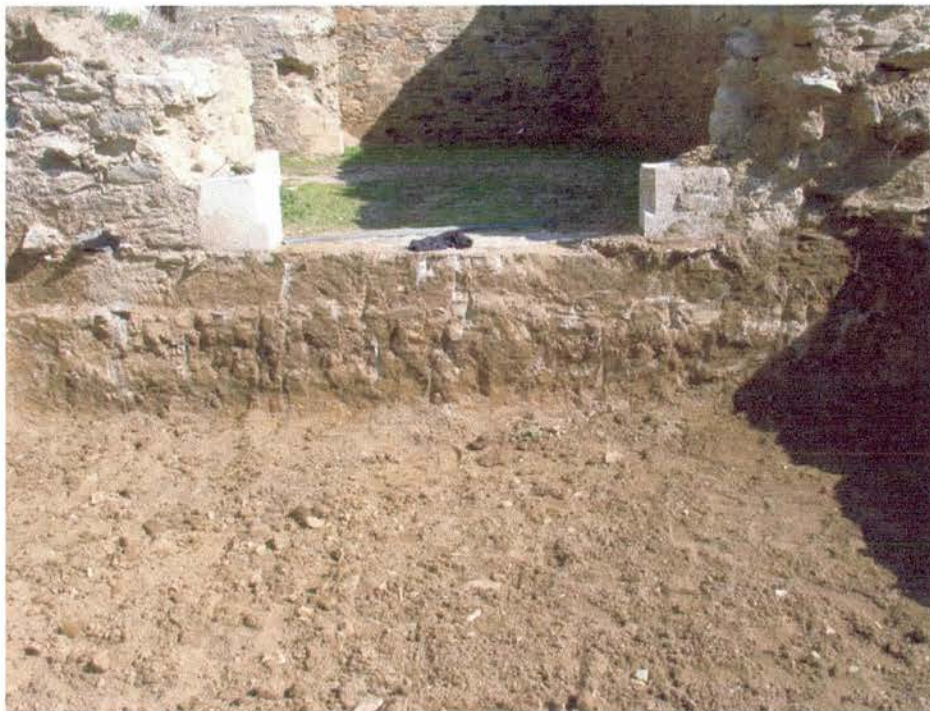
Fig. 5: Porta d'entrada, emmarcada amb carreus, corresponent a la casamata del flanc nord del baluard. A banda i banda de la porta s'aprecien algunes pedres de la lligada que havia de servir per a unir amb l'obra dels túnels d'accés que no s'arribaren a construir
