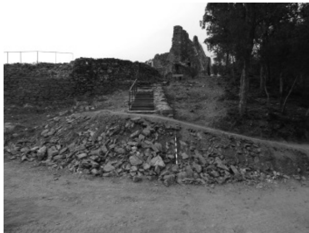
Figura 7. Detall de la zona d'accés (zona 4) un cop finalitzats els treballs d'adequació.
