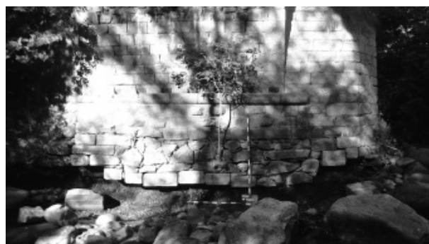
Figura 6. Aspecte del basament afectat per l’erosió.
