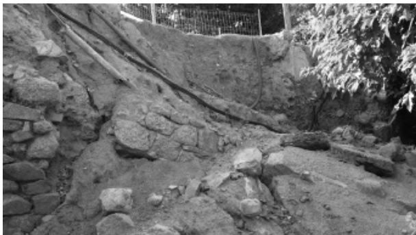
Figura 3. Detall de l'esfondrament del mur de contenció entre la plaça de l'església i el restaurant de sota.
