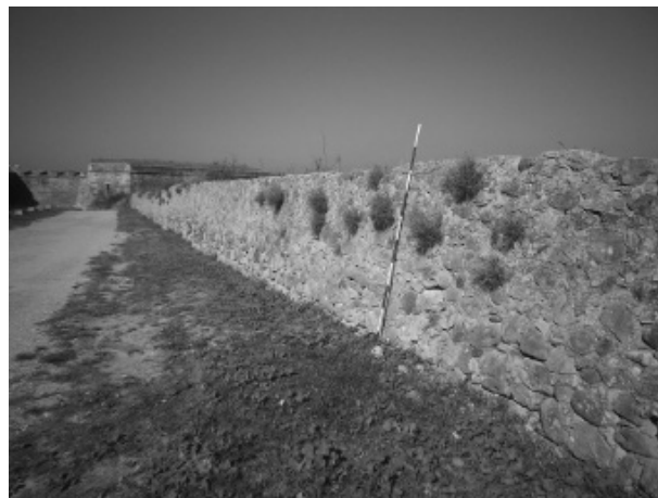
Figura 5. Parapet del camí cobert que flanqueja l'accés a la rampa de vehicles.
