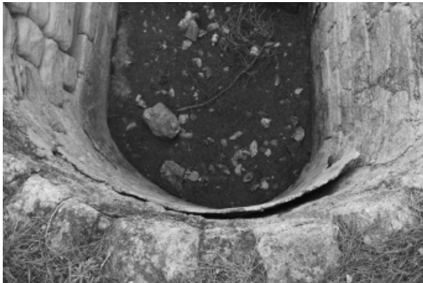
Figura 2. Separació del revestiment de picadís ceràmic de la
