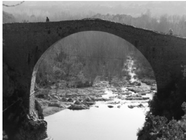
Figura 4. L'estudi del parament del pont permet veure que les baranes actuals no formaven part de la construcció original gòtica, sinó que són una reforma posterior.
