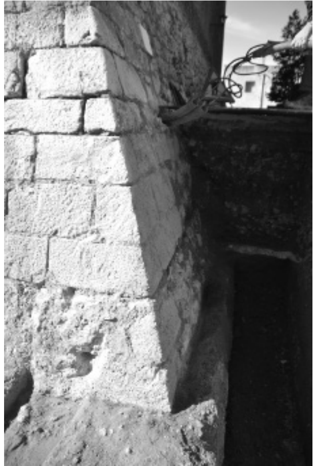
Figura 9. Detall de l'angle NE de l'escarpa de l'església. Al fons de la cala es veu el paviment de morter que quedaria a nivell de la base del fossat d'aquest costat.
