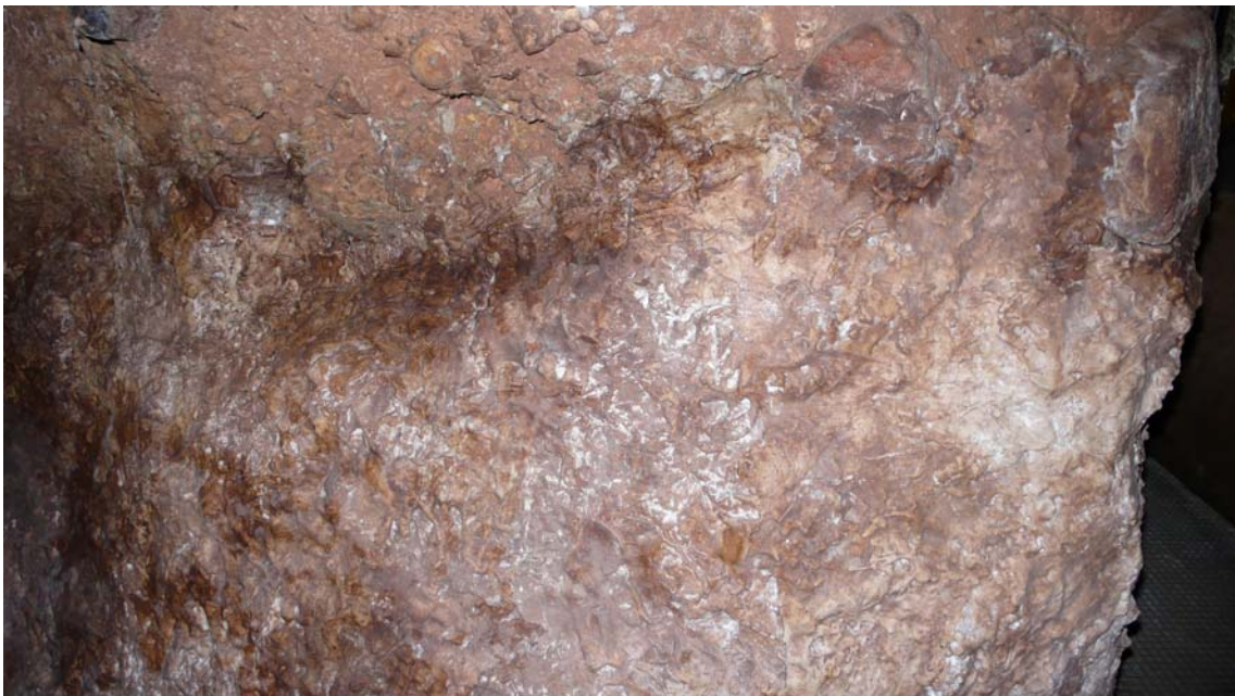
Figura 17.- Detall del cobriment del nivell If. Es pot observar la textura i coloració donada als materials emprats per protegir les seccions.
