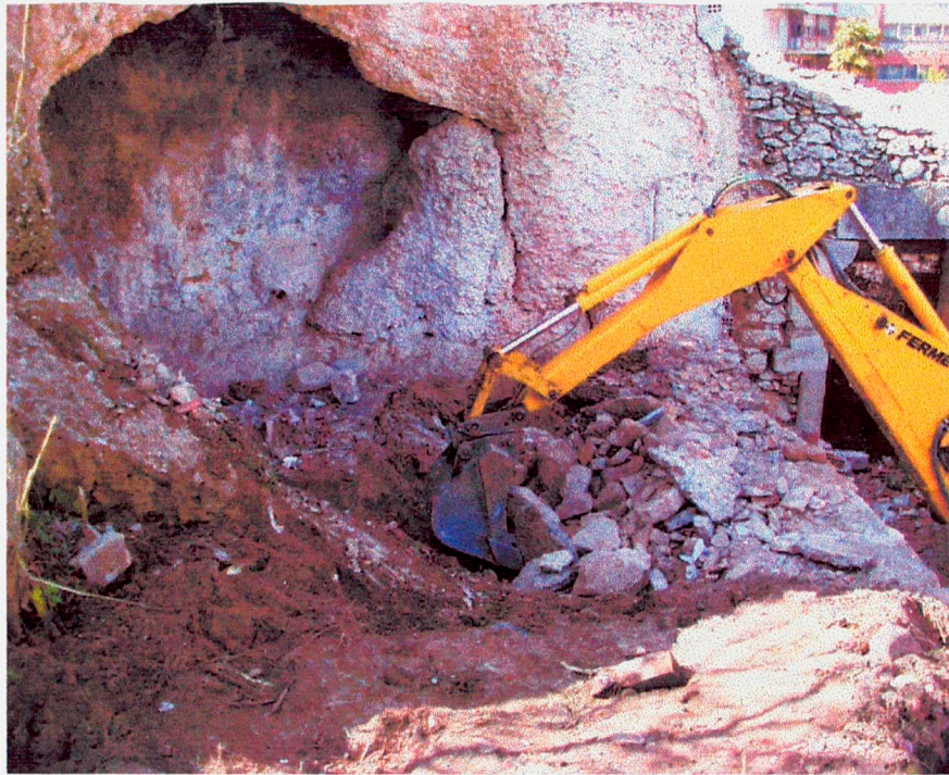
Figura 5. Inici dels treballs de buidat del rebliment del moll de càrrega, situat a l'exterior de la boca nord de l'extrem est de la Cova del Quincall.
